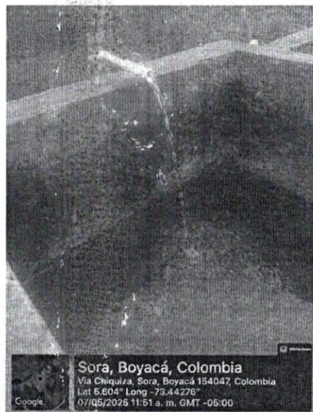
Suministro de agua para el sector suacha barrial casa del usuario Luis Emilio Suarez
