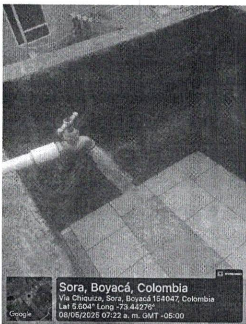
Suministro de agua sector la mina y las juntas
