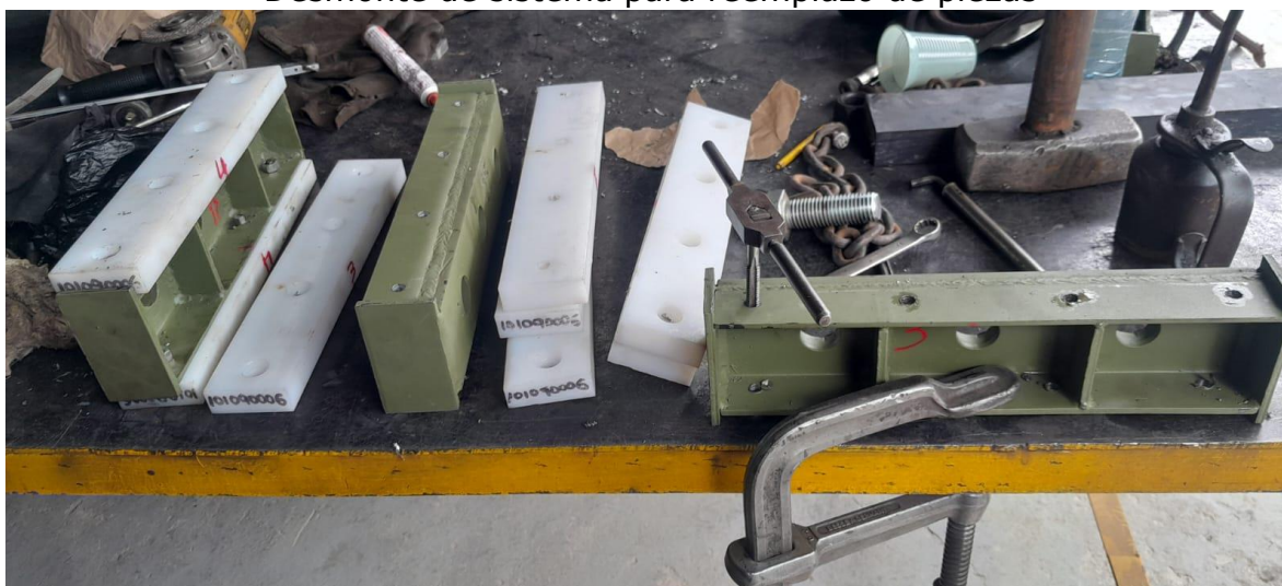
Instalación de sistema de movimiento de cuchilla
