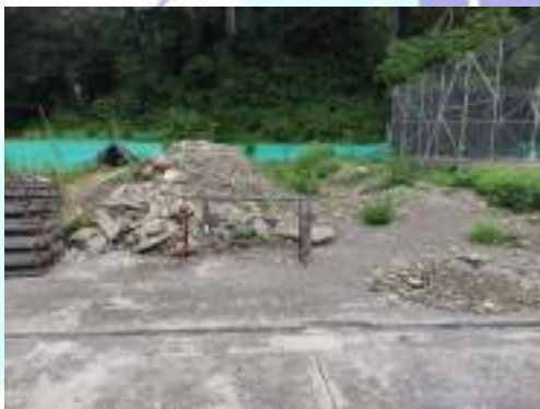
Materiales de obra por demolición sin protección.
