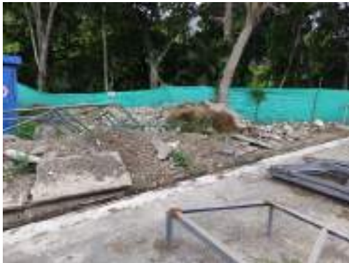
Materiales de obra por demolición sin protección.
