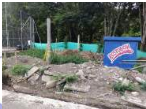
Materiales de obra por demolición sin protección.
