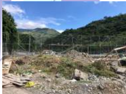
Materiales de obra por demolición sin protección.
