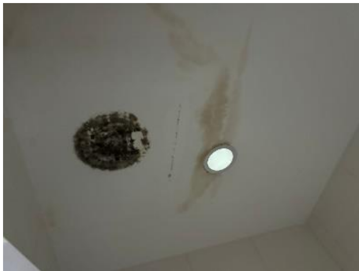
Figura 1. Baños sin sistema de ventilación y/o extracción,
