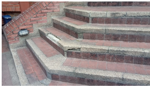
Zona Norte – Afectación evidenciada en la entrada de uno de los edificios intervenidos
