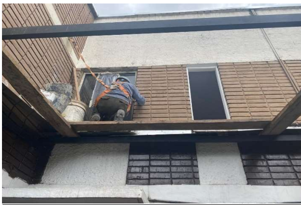
Zona Centro Casa Acapulco 71-35 – Detalles de fillos en ventanas en exteriores e interiores
