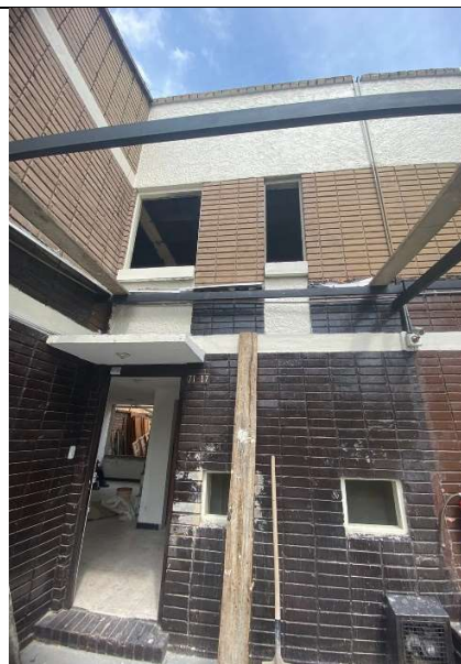
Zona Centro Casa Acapulco 71-17 Pintura fachada exterior
