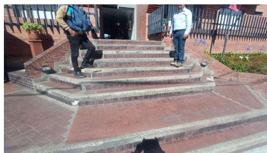
Estado de los escalones de la entrada principal del edificio.
