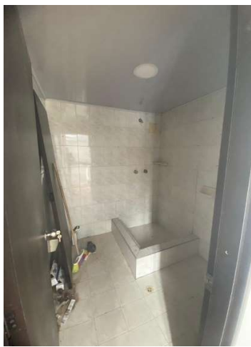
Zona Centro Casa Acapulco 71-17 (Faltan por últimas detalles en baño)
