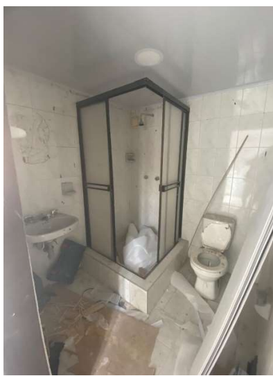
Zona Centro Casa Acapulco 71-11 (Zona de baño por intervenir y limpiar)
