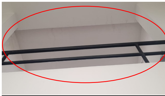
Zona de uno de los apartamentos que presenta signos de filtración y humedad en el cielo raso
