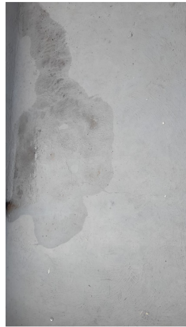
Empozamientos encontrados en la zona de la placa de la cubierta
