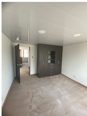
Zona Centro Casa Acapulco 71-11 – Habitación pendiente por realizar actividades de limpieza
