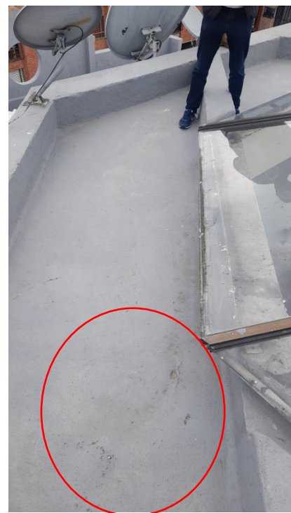
Zona de la cubierta que evidencia posible levantamiento de la impermeabilización.
