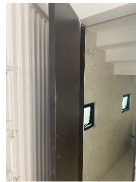
Zona Centro Casa Acapulco 71-11 Puerta pendiente por instalación de cerradura
