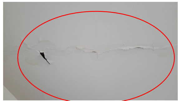
Zona del cielo raso de la zona común que presenta afectaciones producto de las filtraciones que se están generando
