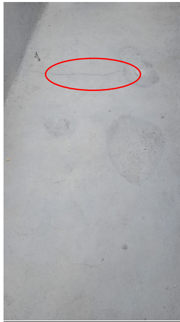
Agrietamientos encontrados en la zona de la placa de la cubierta
