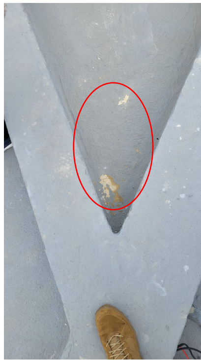
Desprendimiento de la impermeabilización
