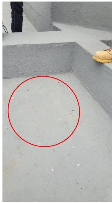
Zona de la placa impermeabilizada que muestra signos de levantamiento y agrietamiento considerable
