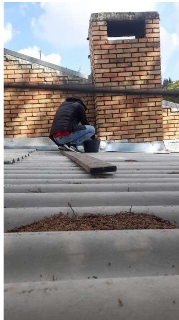
Subsanación gotera encontrada en una de las casas(143-38).
