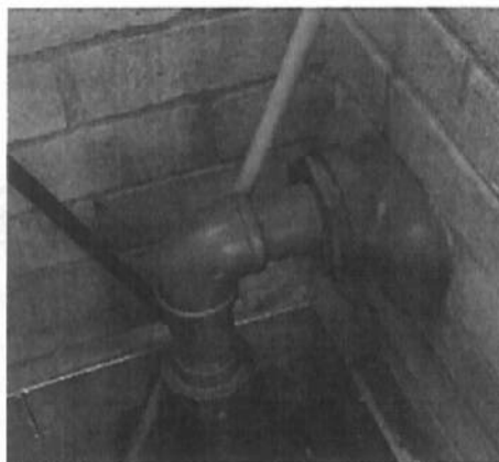
Ilustración 2 Conexión siamesa sin válvula de retención
