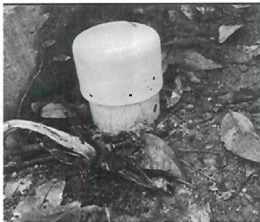
Ilustración 2 Tapón en PVC descarga de la bomba
