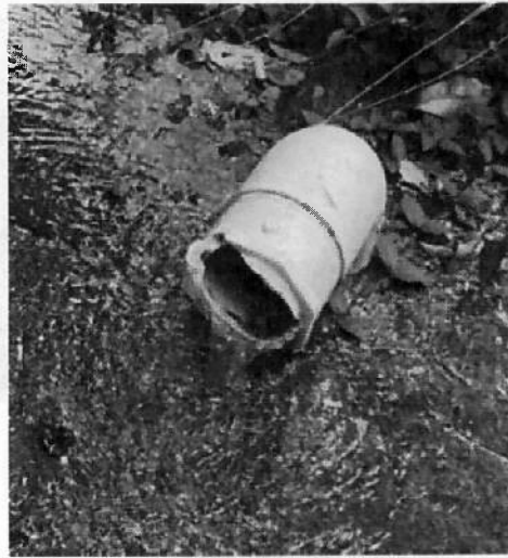
Ilustración 5 Descarga de la bomba
