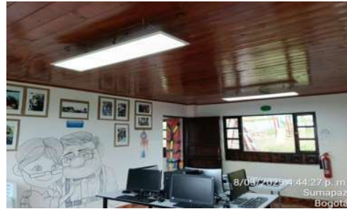
FECHA FOTO: 8/03/2025 DESCRIPCIÓN: Verificación funcionamiento luminarias.
