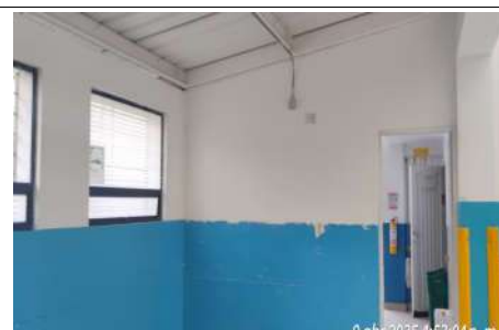
FECHA FOTO: 09/04/2025 DESCRIPCIÓN: pintura de zona afectada por filtracion de agua, se puso Flanche para superar el problema
