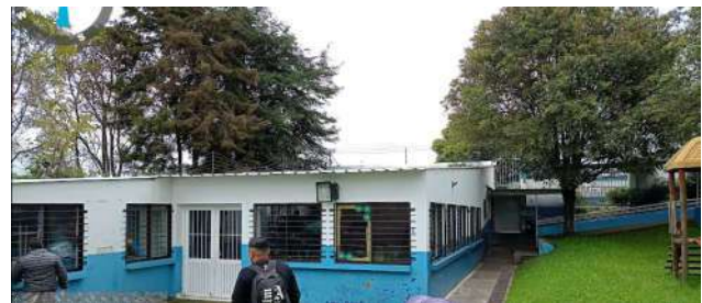
FECHA FOTO: 27/03/2025 DESCRIPCIÓN: Identificación de ventanería en mal estado a reponer
