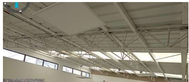
FECHA FOTO: 27/03/2025 DESCRIPCIÓN: luminarias instaladas
