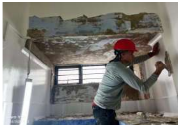
FECHA FOTO: 03/04/2025 DESCRIPCIÓN: Resane de humedad en cocina
