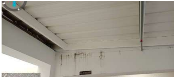
FECHA FOTO: 27/03/2025 DESCRIPCIÓN: Problemas de humedad por resaca y pintar
