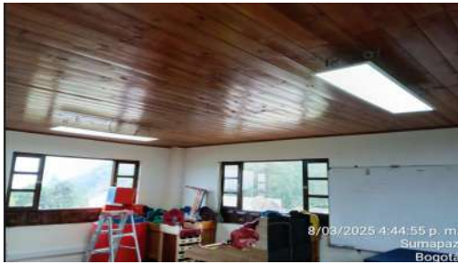
FECHA FOTO: 8/03/2025 DESCRIPCIÓN: Verificación funcionamiento luminarias.
