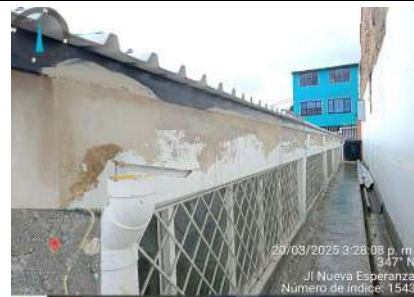
FECHA FOTO: DESCRIPCIÓN: Falta Instalar Canal de recoleccion de aguas lluvia.
