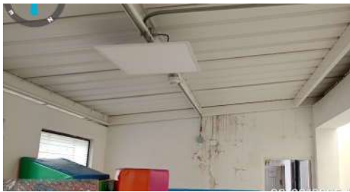
FECHA FOTO: 27/03/2025 DESCRIPCIÓN: luminarias instaladas
