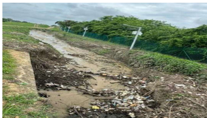
Ilustración 4 Estado actual de los Canales en el Aeropuerto
