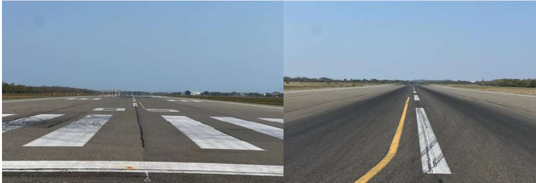
Ilustración 6 Estado Actual del Pavimento Asfáltico del Aeropuerto
