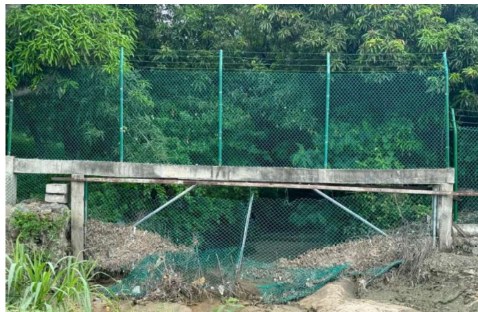
Ilustración 5 Estado Actual del Cerramiento en el Aeropuerto
