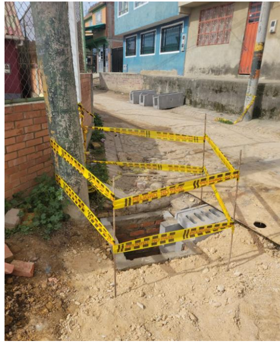
FOTO NO. 16 SEÑALIZACION
