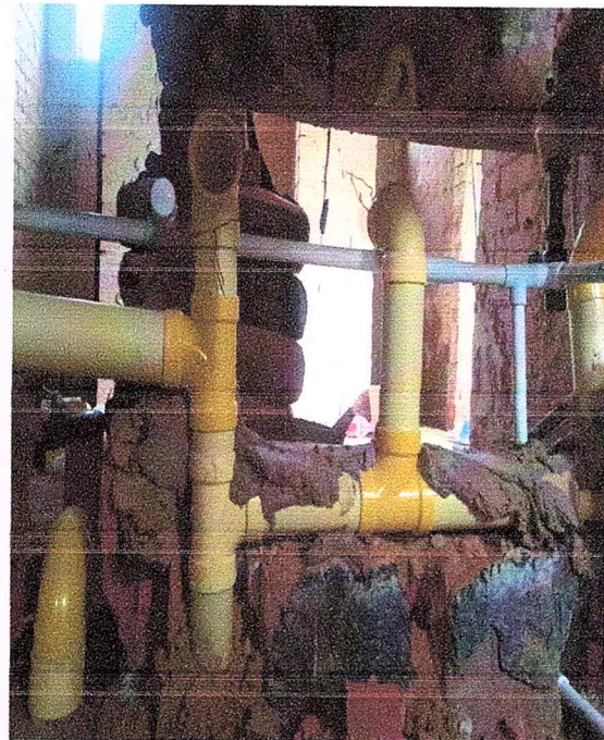
Foto 14. Se realizó la instalación de puntos de desagüe para orinal y duchas, buscando asegurar una correcta conducción y salida de estas.
