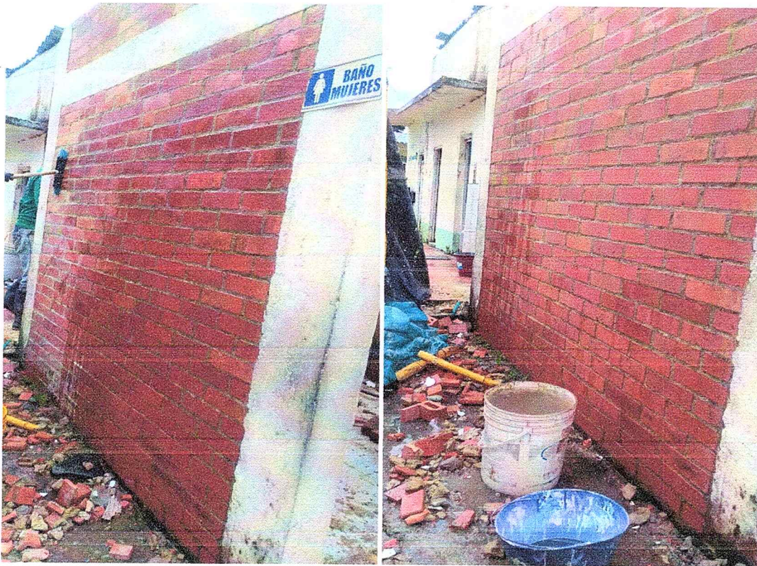
Foto 9. Lavado de la fachada en muros utilizando ácido muriático para mejorar el acabado y eliminar suciedad acumulada.
