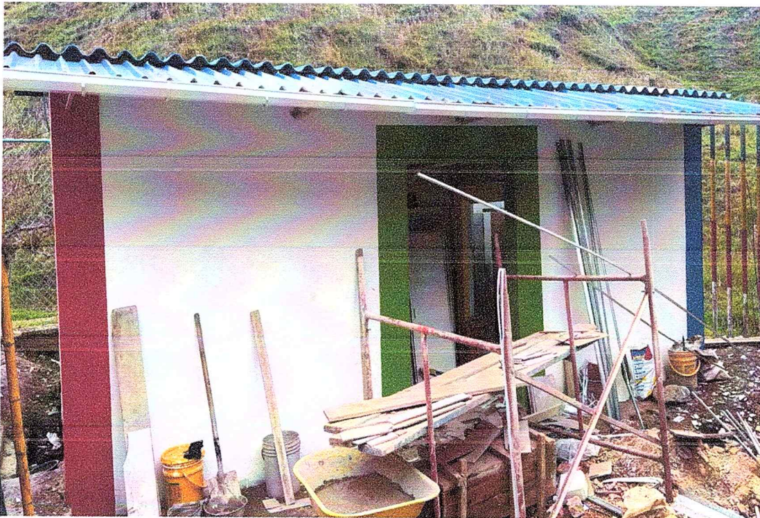
Foto 18. Se aplico vinilo tipo 1 sobre muros en estuco o pañete, logrando un acabado continuo y de calidad.
