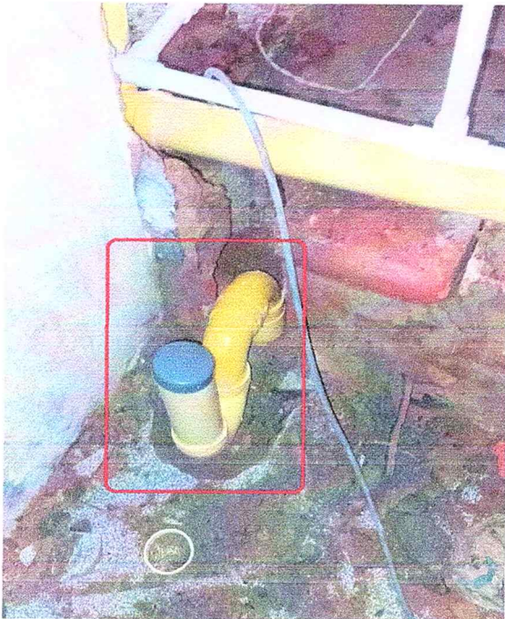
Foto 13. Se realizó la instalación de puntos de desagüe para orinal y duchas, buscando asegurar una correcta conducción y salida de estas.
