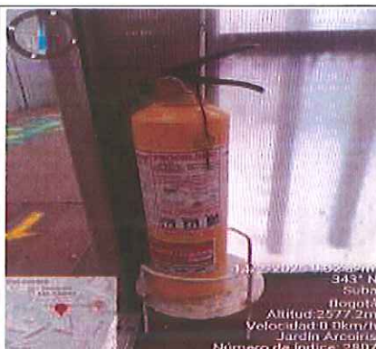
Foto 80. Inspección de Kit de emergencias en frente de obra Arcoíris. FUENTE: Elaboración propia
