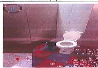
Foto 181. Inspección de unidad de baño sanitaria en frente de obra Arcoiris. FUENTE: Elaboración propia
