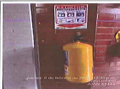
Foto 175. Inspección de Kit de emergencias en frente de obra Juan XXIII. FUENTE: Elaboración propia
