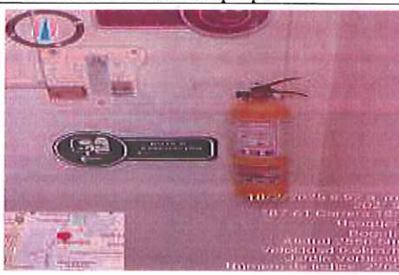
Foto 60. Inspección de Kit de emergencias en frente de obra El Verbenal.
