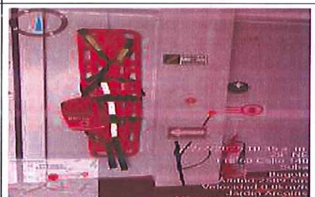
Foto 183. Inspección de Kit de emergencias en frente de obra Arcoiris. FUENTE: Elaboración propia
