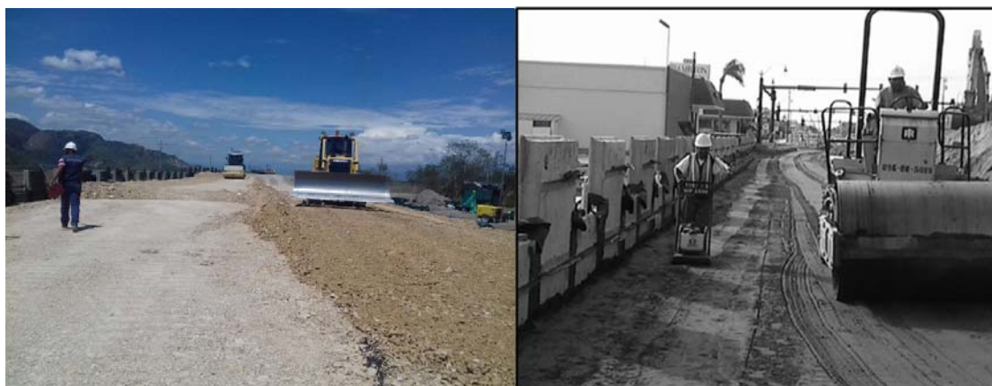
Figura 169. Extensión de relleno compactado.
