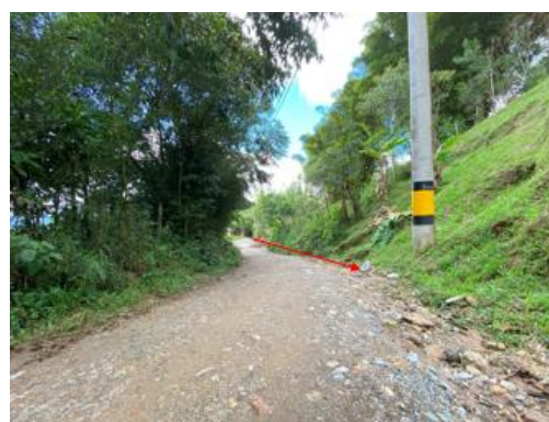
k01+260 al k01+350 hundimiento de vía
