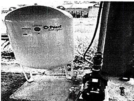
Foto No. 15 SISTEMA HIDROFLOW
