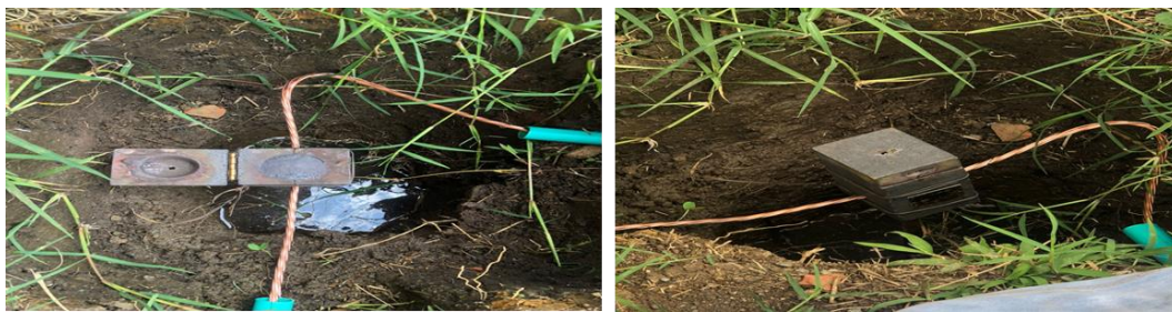
Ilustración 26 Malla a tierra
