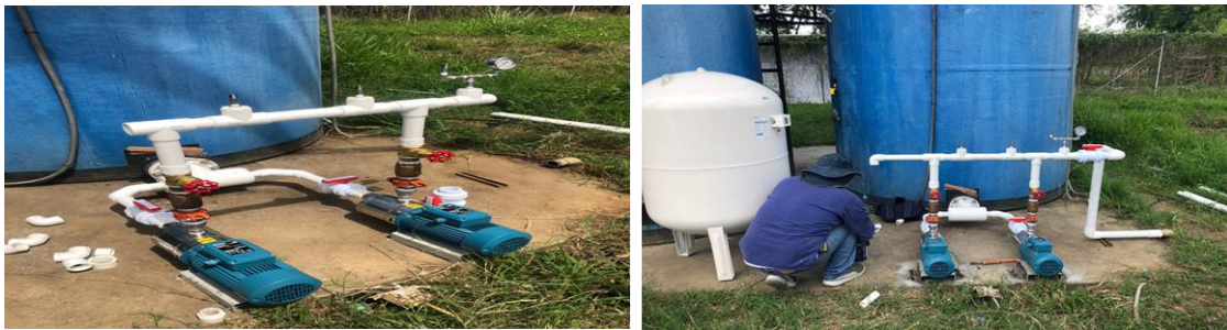
Ilustración 32 Sistema de Motobomba
