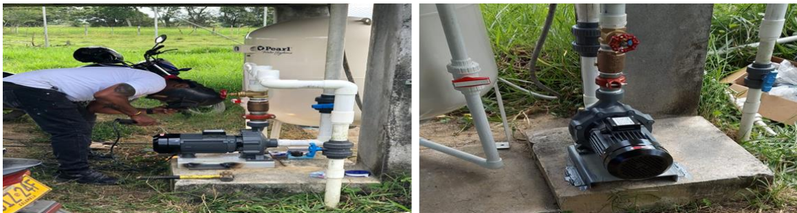
Ilustración 31 Sistema de motobombas
