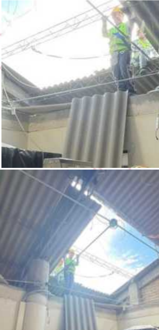
Foto 3. DESMONTE DE CUBIERTA FIBROCEMENTO LÁMINA ONDULADA DE ZINC Y TEJA DEL SEGUNDO NIVEL
