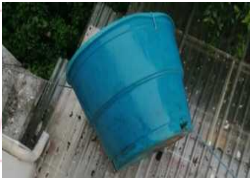
Foto. DESMONTE, TRASLADO Y REUBICACION DE TANQUES DE ALMACENAMIENTO DE AGUA A PATIO POSTERIOR
