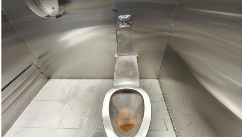
Foto # 3. Los sanitarios están fallando y los sistemas de agua
