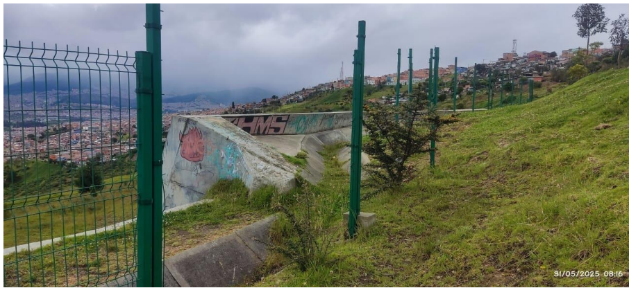
Fotos # 8, 9 y 10 Falta la malla de protección del muro de contención, zona peligrosa hay un abismo
