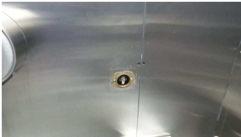
Foto # 2 . Plus en mal estado de los orinales y los sanitarios
