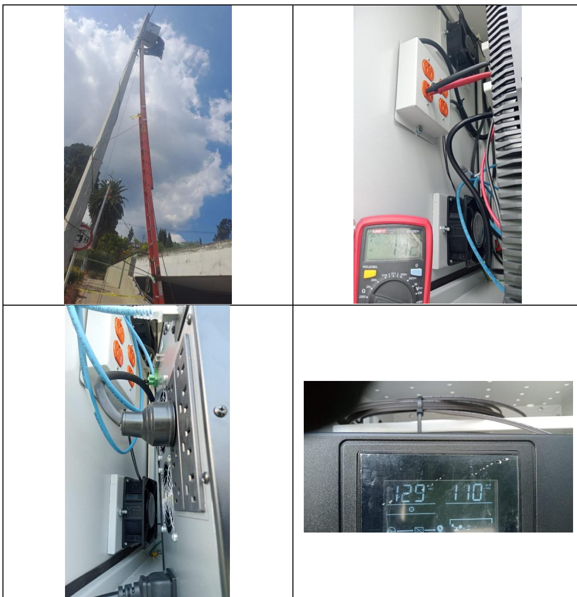
Imagen 11. ID 2168 Instalación de UPS CONFIGURADA, energía regulada en el punto
