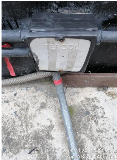
Caja de Energía
