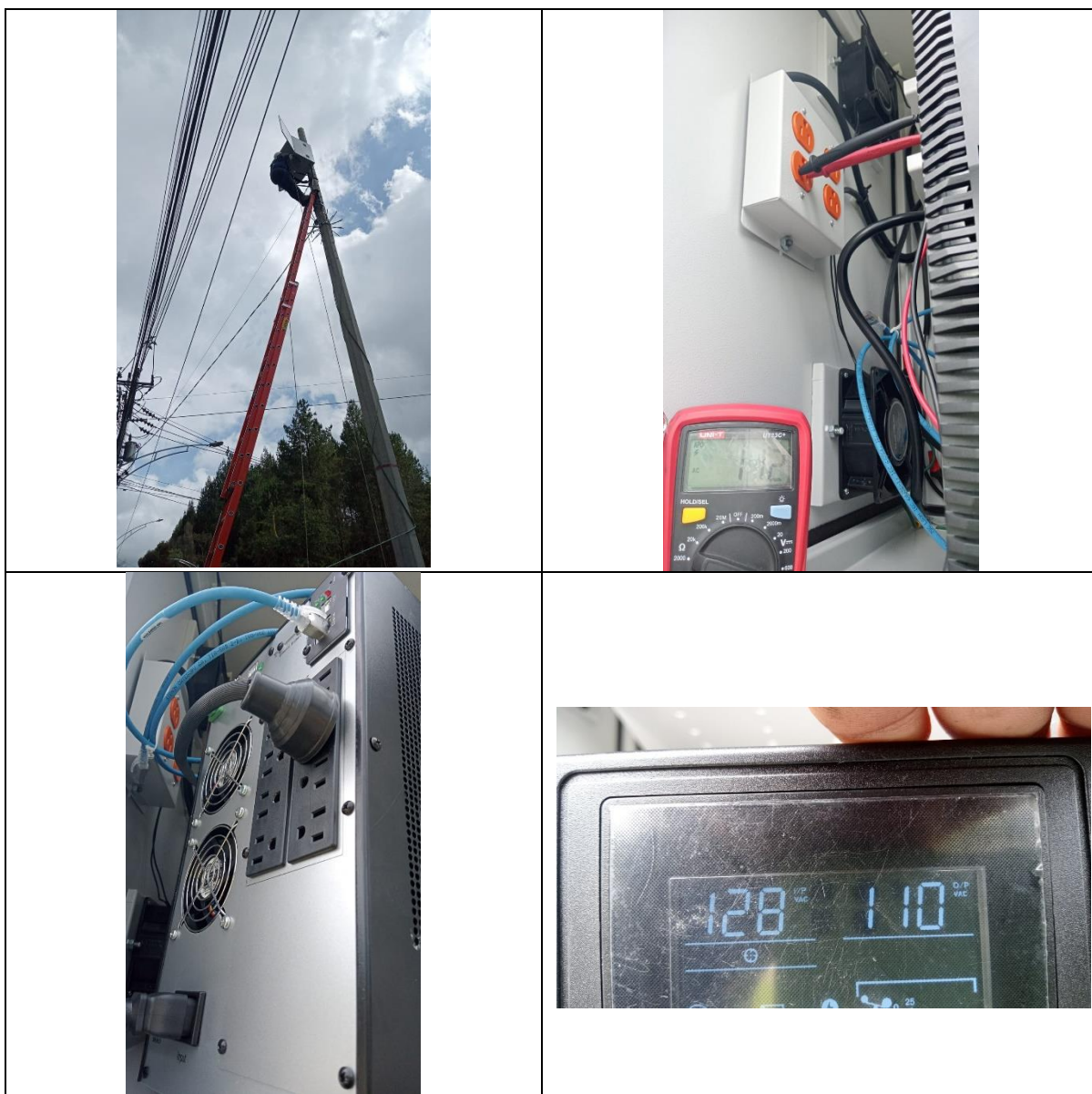
Imagen 8. ID 2175 Instalación de UPS CONFIGURADA, energía regulada en el punto
