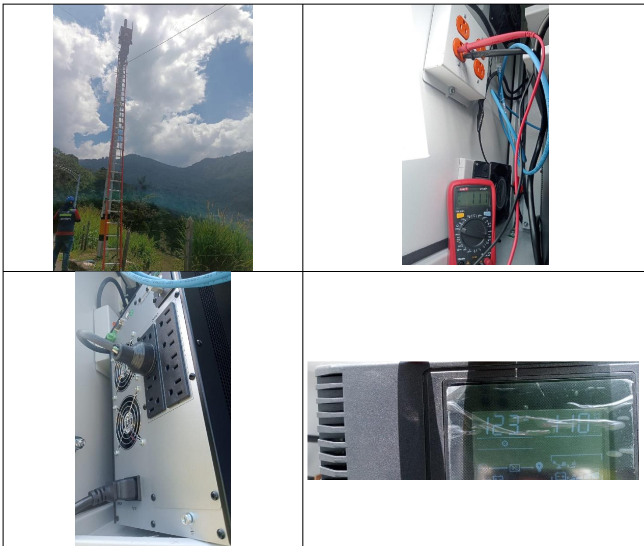
Imagen 10. ID 2177 Instalación de UPS CONFIGURADA, energía regulada en el punto
