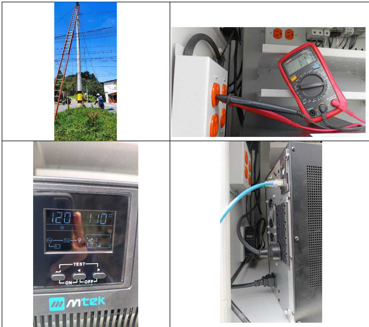
Imagen 2. ID 2176 Instalación de UPS CONFIGURADA, energía regulada en el punto.
