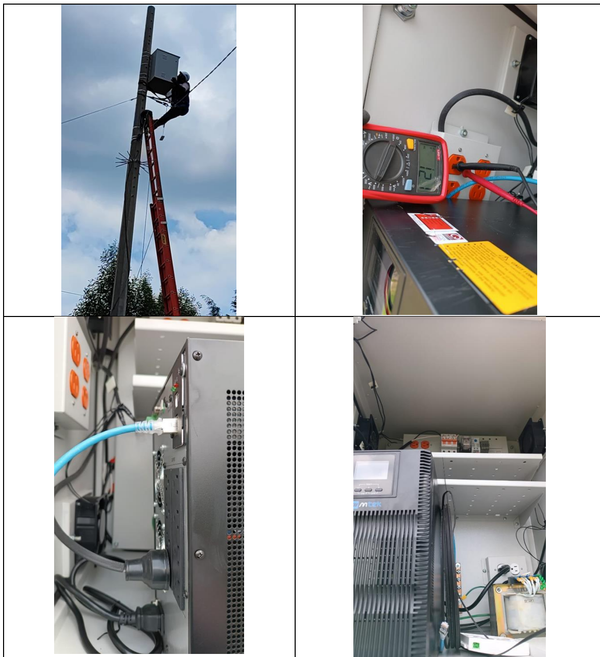
Imagen 3. ID 2170 Instalación de UPS CONFIGURADA, energía regulada en el punto
