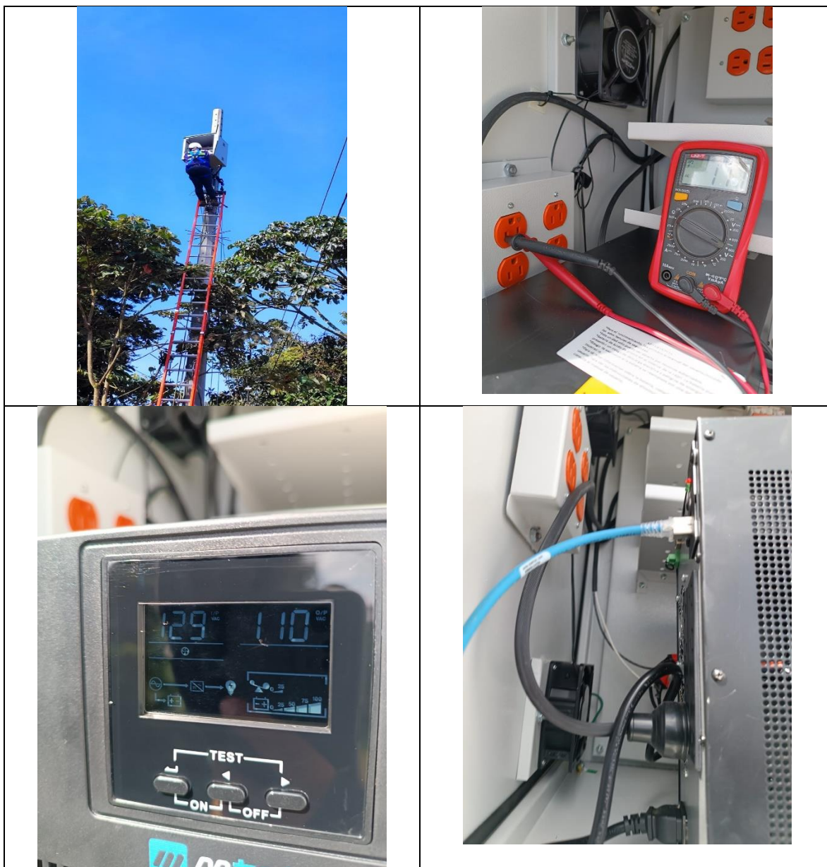
Imagen 1. ID 2171 Instalación de UPS CONFIGURADA, energía regulada en el punto.
