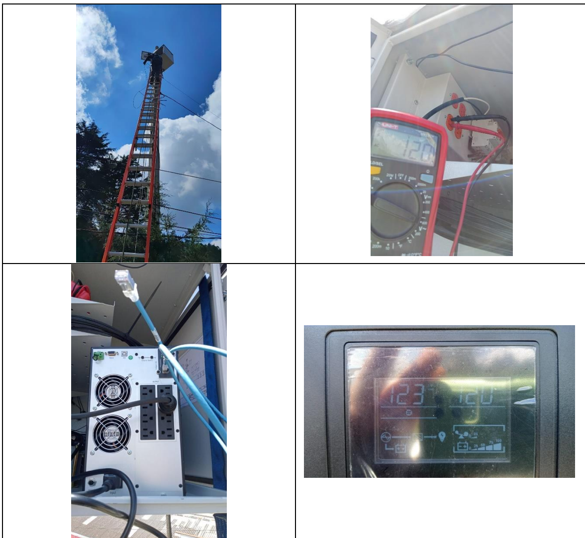
Imagen 6. ID 2172 Instalación de UPS CONFIGURADA, energía regulada en el punto
