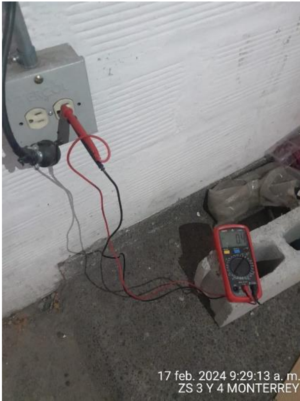
Acometida del gabinete sin voltaje
