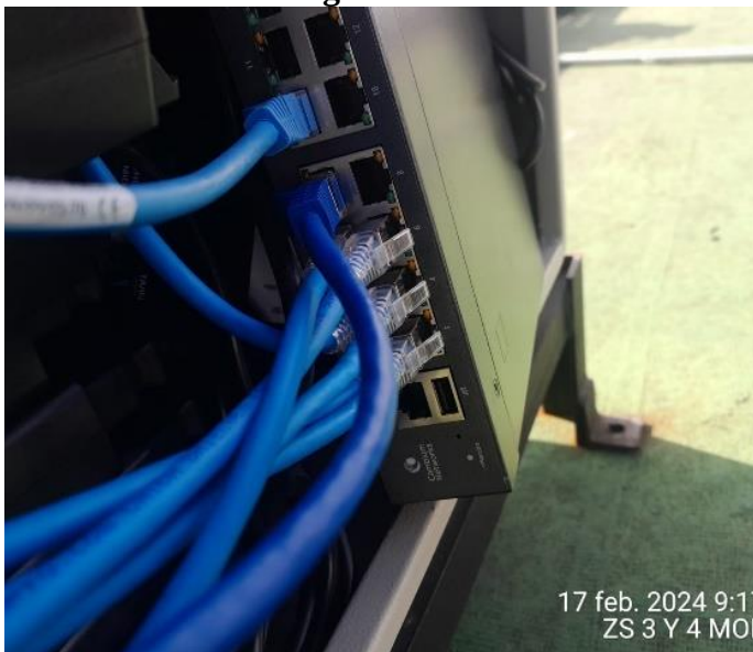
Gabinete sin energía
