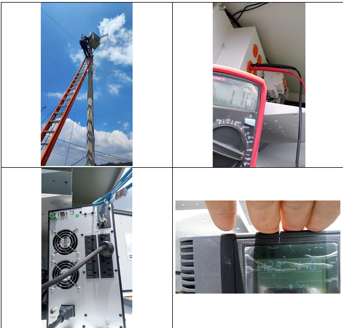
Imagen 7. ID 2178 Instalación de UPS CONFIGURADA, energía regulada en el punto
