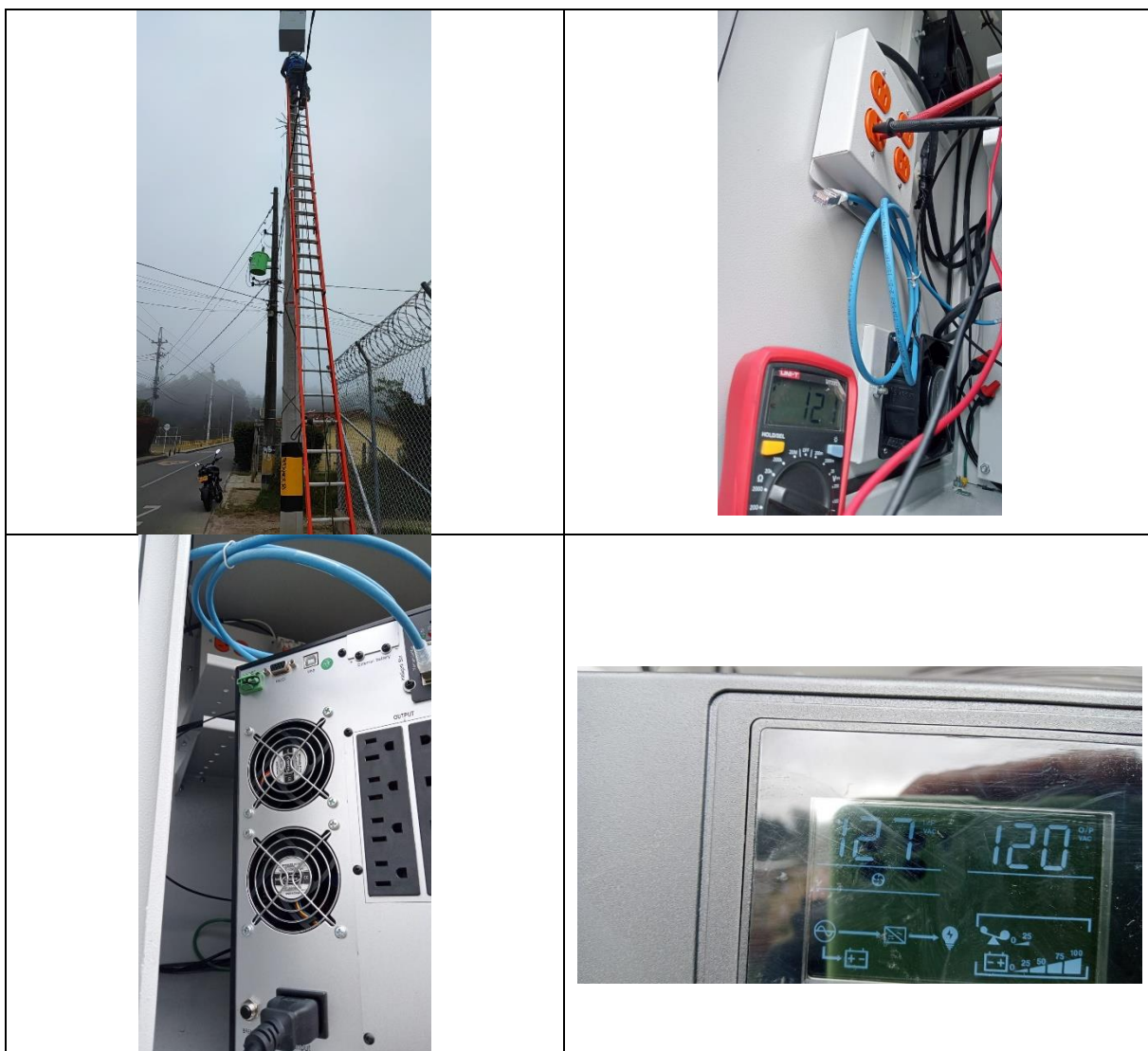
Imagen 5. ID 2169 Instalación de UPS CONFIGURADA, energía regulada en el punto
