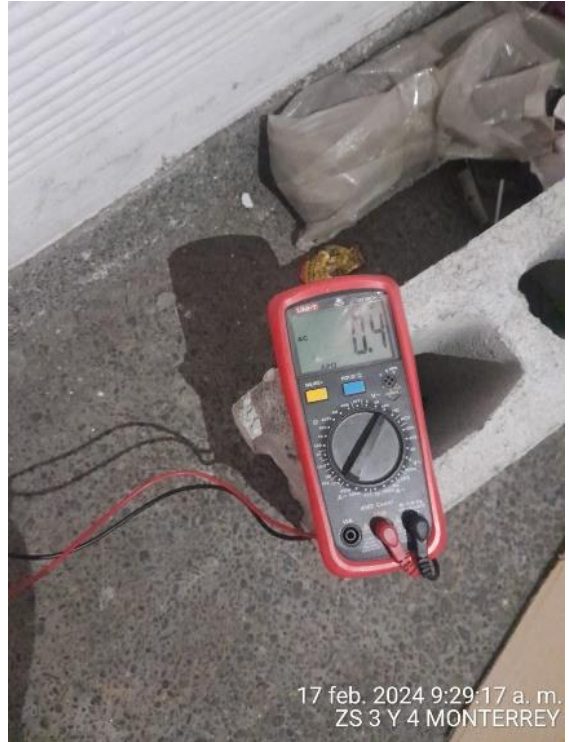
Acometida del gabinete sin voltaje
