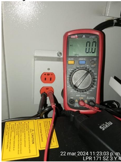
Voltaje en Gabinete
