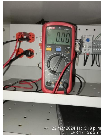
Voltaje en Gabinete
