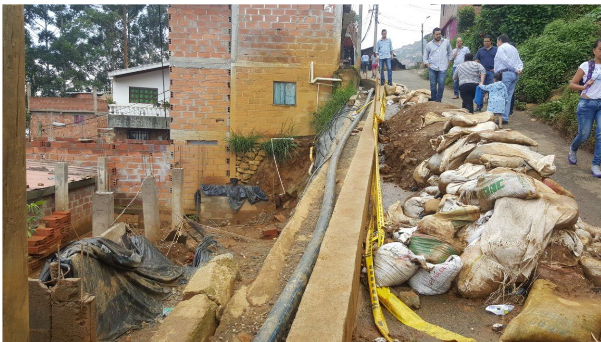
Fotografía 1. Vista general de la problemática presentada sobre la vía.
