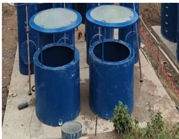
Ilustración 33 Unidades de lechos de secado.
