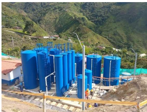
Ilustración 30 Unidades de floculación.
