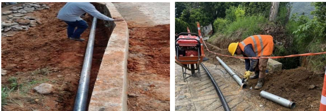
Ilustración 68 Registro de encamisado en 4" en la vía Los Alticos
