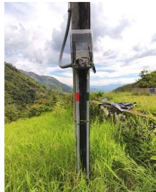
Ilustración 46 Bajante redes electricas.
