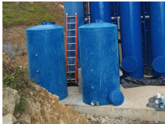
Ilustración 35 Espesadores de lodos.
