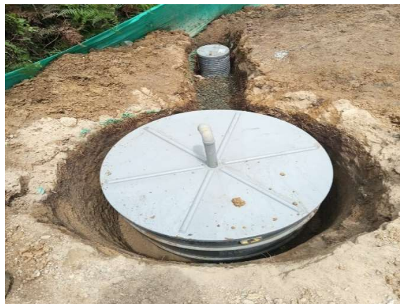
Ilustración 42 Tanque séptico instalado
