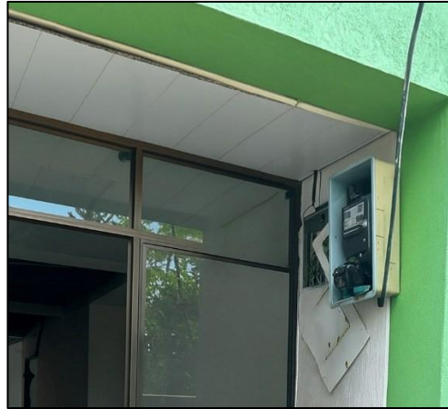
Ilustración 24. Caja medidor trifásica
