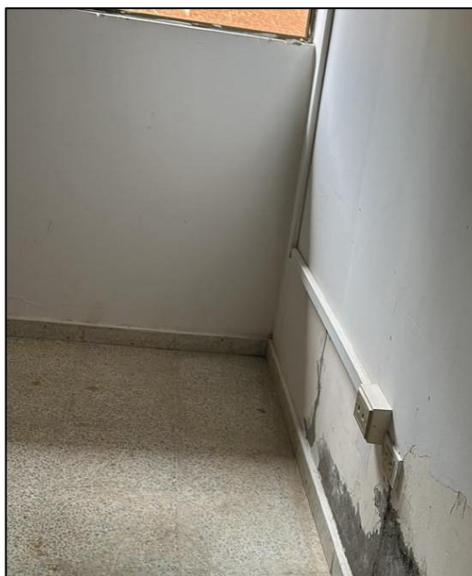
Ilustración 29. Puntos eléctricos de 110 V
