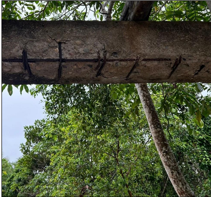
Ilustración 6. Acero en deterioro
