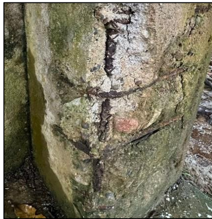
Ilustración 5. Acero en deterioro
