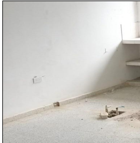
Ilustración 30. Punto eléctrico del compresor antiguo
