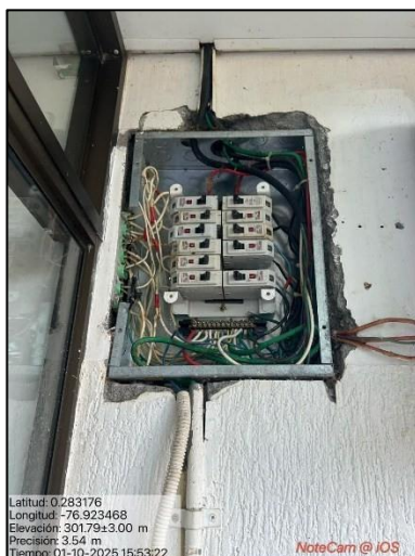
Ilustración 25. Tablero de control actual
