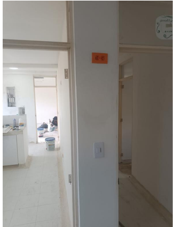
5.3. Interruptores y tomas
