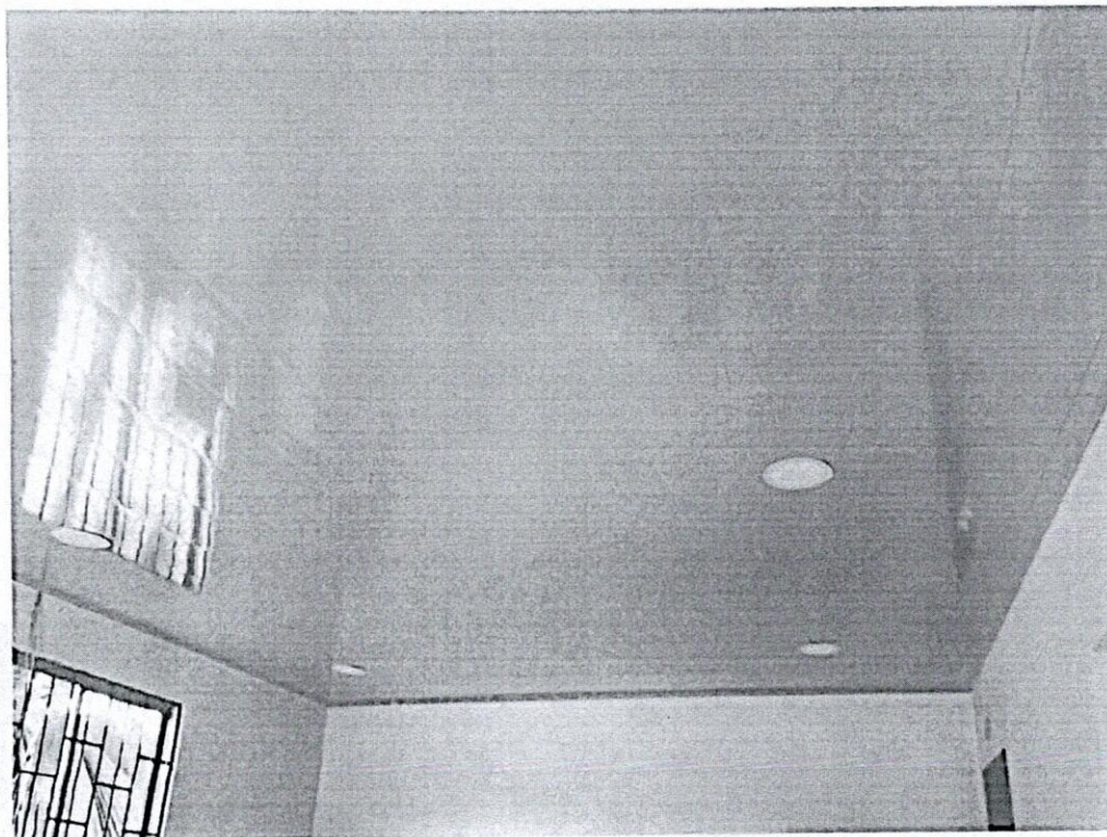
CIELO RASO EN PVC Y LUMINARIAS
