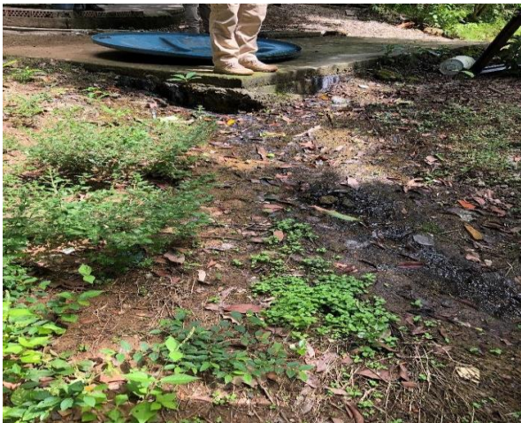
Imagen 2: Filtración del tanque séptico existente.
