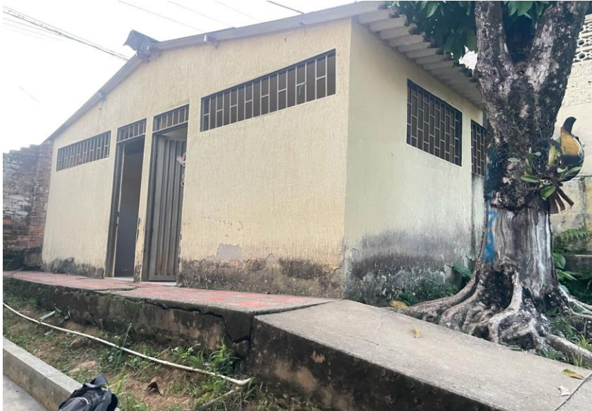
Pintura existente batería sanitaria camilo torres
