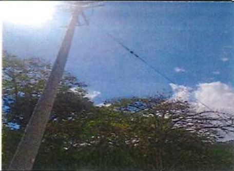
Retenidas de baja tensión para postes de concreto
