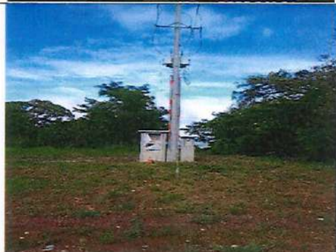
Instalación de protección de la media tensión
