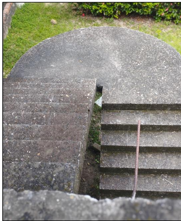
Ilustración 47: Escalera autoportante espesor y refuerzo insuficientes.
