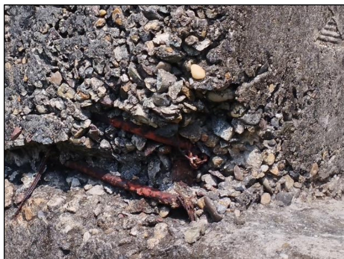
Ilustración 25: Acero de refuerzo longitudinal y transversal expuesto (Columna)
