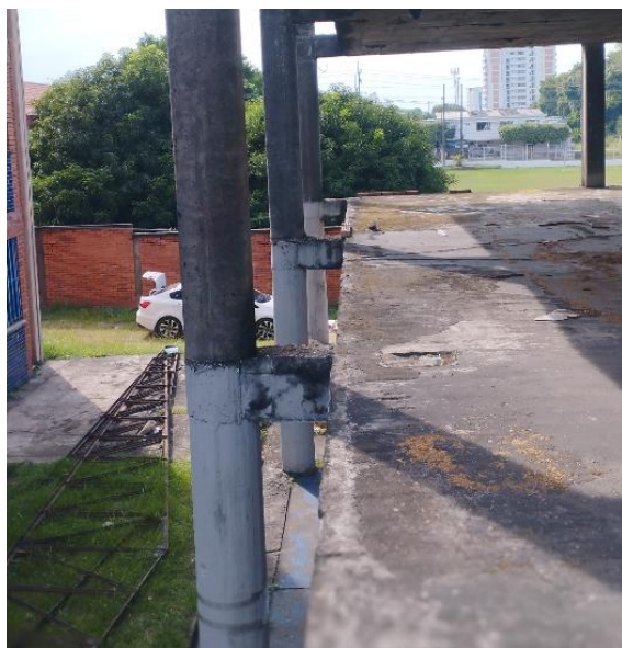
Ilustración 48: Vigas cortas de gran rigidez con refuerzo insuficiente (Entrepisos 1 y 2).
