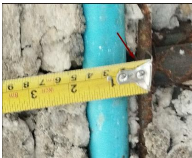
Ilustración 29: Acero de refuerzo transversal expuesto (Vigas)
