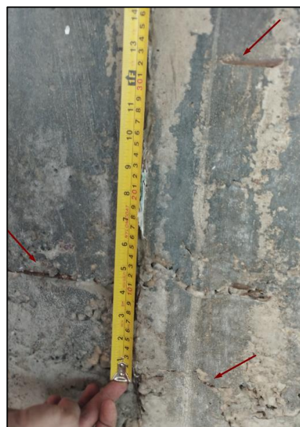
Ilustración 30: Acero de refuerzo longitudinal y transversal expuesto (Columna)
