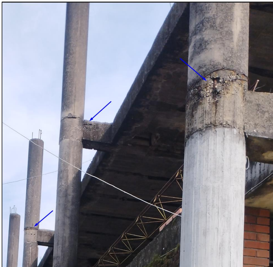
Ilustración 50: Exposición de refuerzo longitudinal de columna circular, hormigoneo de concreto de nudos viga columna, acero de refuerzo transversal de columnas expuesto por ausencia de recubrimiento.
