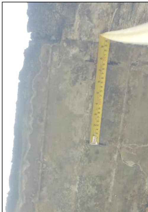
Ilustración 28: Acero de refuerzo transversal expuesto (Vigas)
