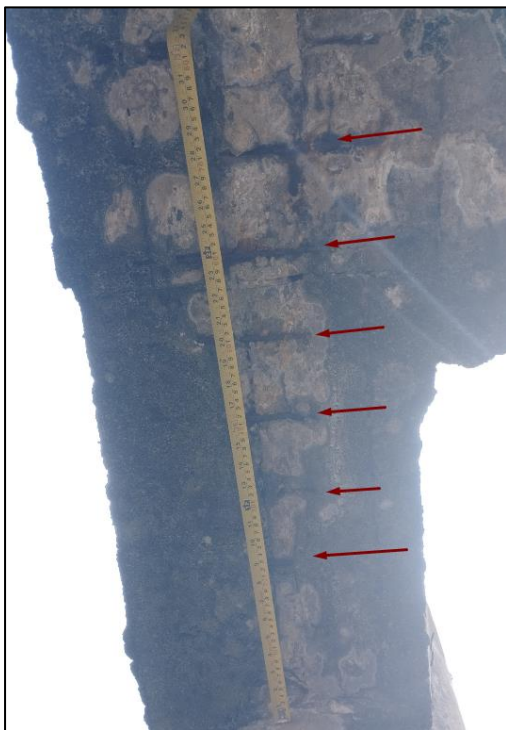
Ilustración 27: Acero de refuerzo transversal expuesto (Vigas)
