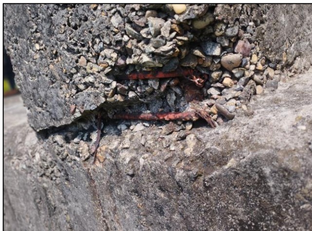
Ilustración 38: Acero longitudinal y transversal expuestos debido a mal proceso constructivo.
