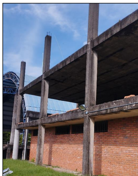
Ilustración 49: Grado de deterioro por exposición ambiental prolongada.
