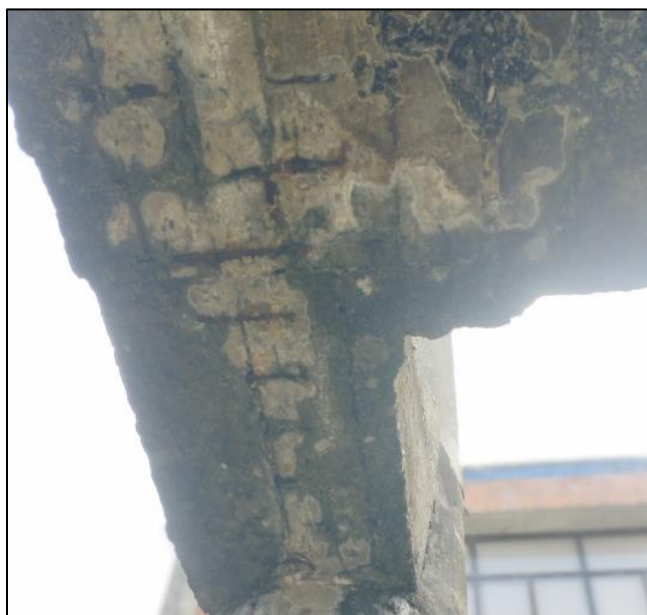
Ilustración 43: Acero transversal de vigas expuesto por falta de recubrimiento (Entrepiso 2)
