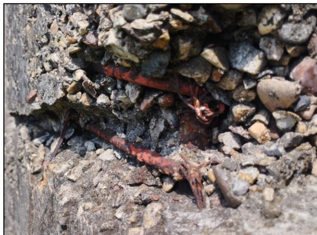
Ilustración 39: Hormigoneo de concreto de columnas, se aprecia agregado grueso deficiente.
