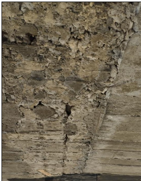
Ilustración 46: Hormigoneo y falta de recubrimiento en vigas interiores de entrepiso 2.
