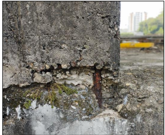
Ilustración 37: Barras de refuerzo expuestas por causa de un mal proceso constructivo.
