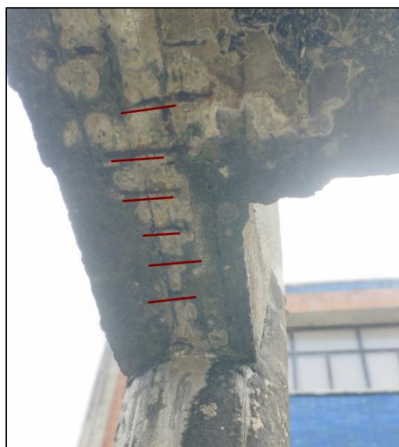
Ilustración 26: Acero de refuerzo transversal expuesto (Vigas)
