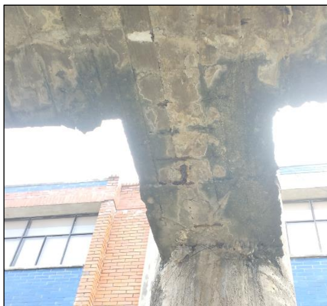
Ilustración 41: Acero transversal de vigas expuesto por falta de recubrimiento (Entrepiso 2)
