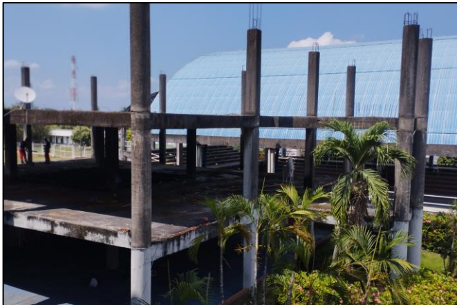
Ilustración 36: Grado de deterioro por exposición ambiental prolongada.
