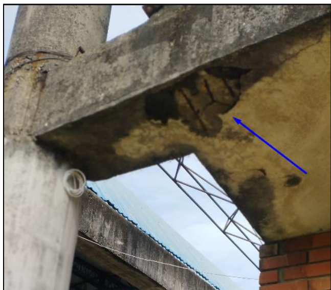
Ilustración 45: Acero transversal de vigas expuesto por falta de recubrimiento (Entrepiso 1)
