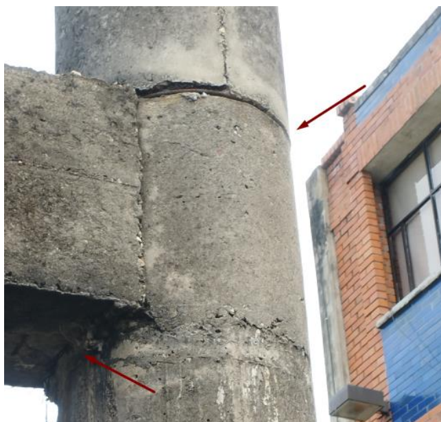
Ilustración 42: Estribos en espiral de columnas expuestos, falta de recubrimiento.
