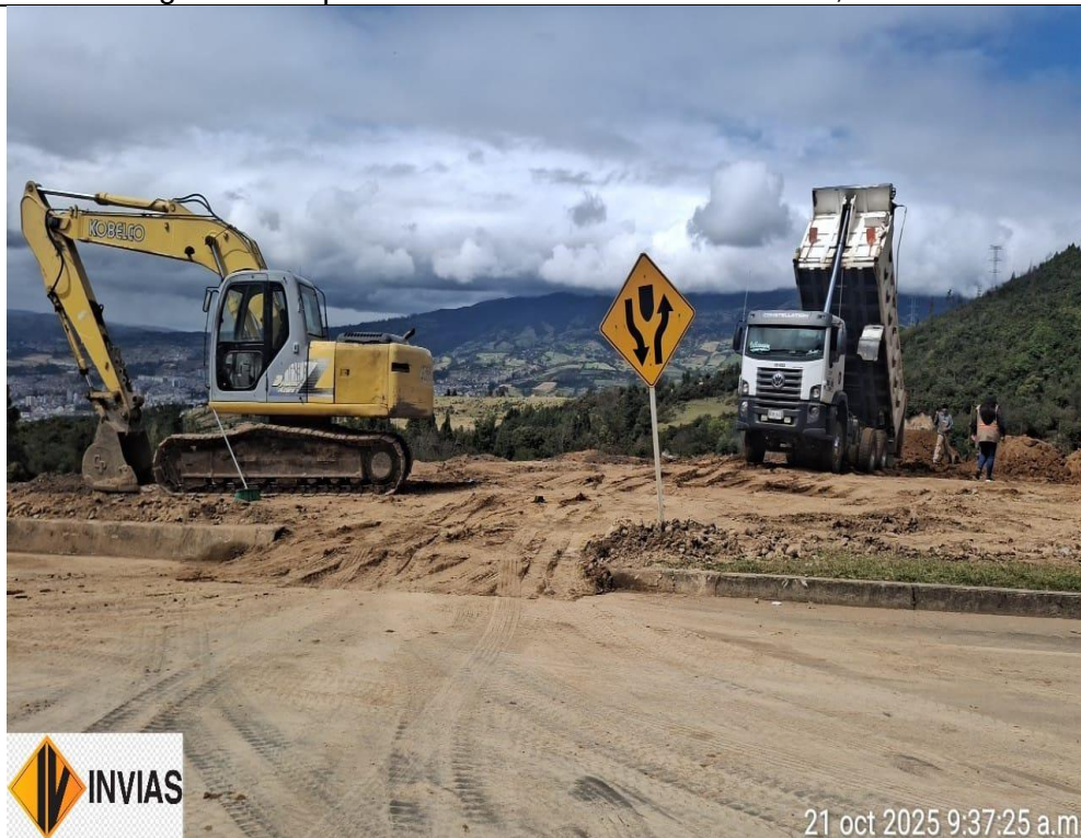
Visita técnica invasión faja de uso de vía, ruta 2502 pr18+0200
