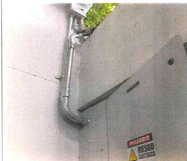
1,02 SUMINISTRO E INSTALACION DE DUCTERIA EN TUBO GALVANIZADO IMC DE ø1-1/2", INCLUYE UNIONES, GRAPAS Y ACCESORIOS DE MONTAJE, PARA SUBACOMETIDA A TABLERO
