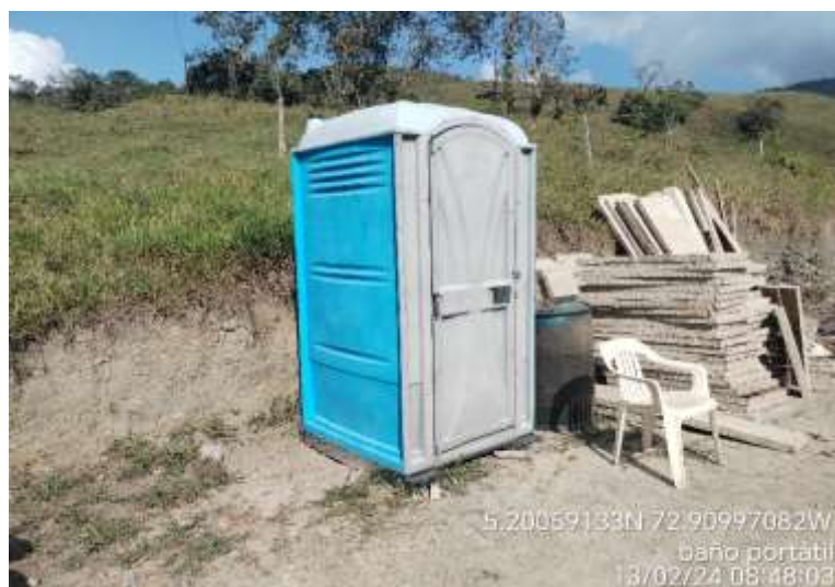
Fotografía No.1 Baño portátil en obra
