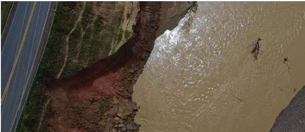
Foto 5. Talud de la vía afectado.
