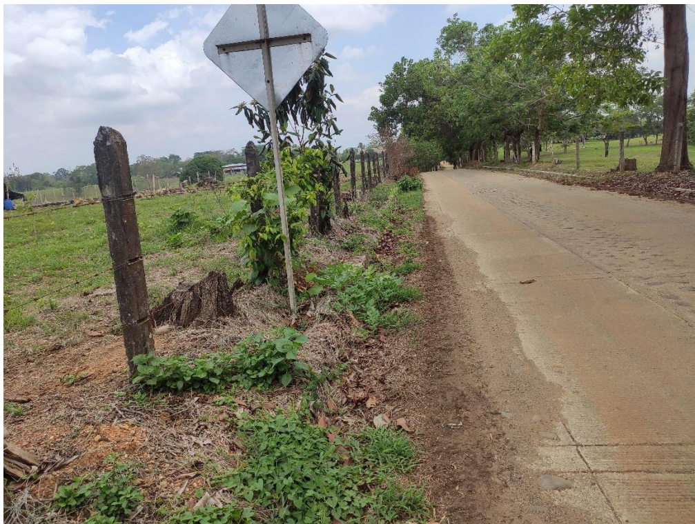
Como observación del recorrido se plantea la inquietud del Mantenimiento de la Placa Huella construida, pues se observa en vía de deterioro por falta de Limpieza de cunetas y mantenimiento general del pavimento existente (Placa Huella)
