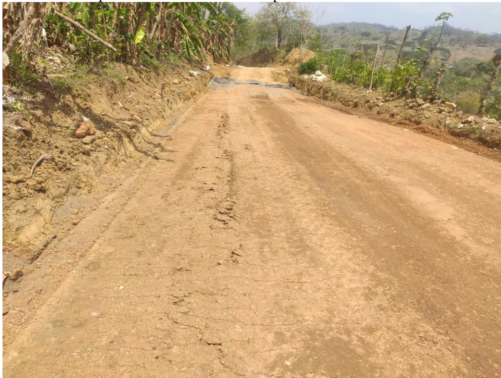
Tramo que presenta deformaciones en su conformación, por posible incumplimiento en su plasticidad o por la necesidad de estabilizar la subrasante que en esta zona se observó bastante blanda.
