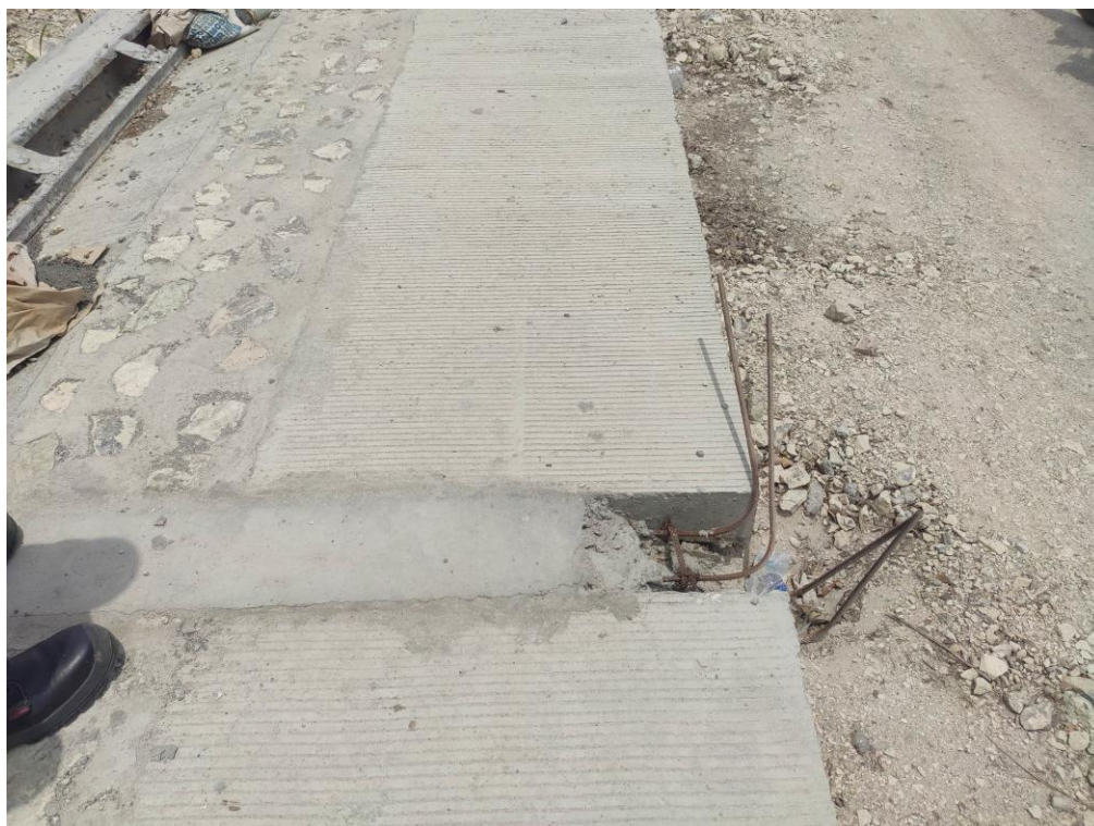
Vigas Riostras mal fundidas, lo que al futuro generara Fisuracion de las mismas e inicio de daños prematuros en la Estructura de la Placa Huella.
