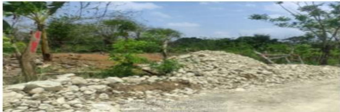
Foto 8. Materiales en zonas no destinadas para su almacenamiento.
