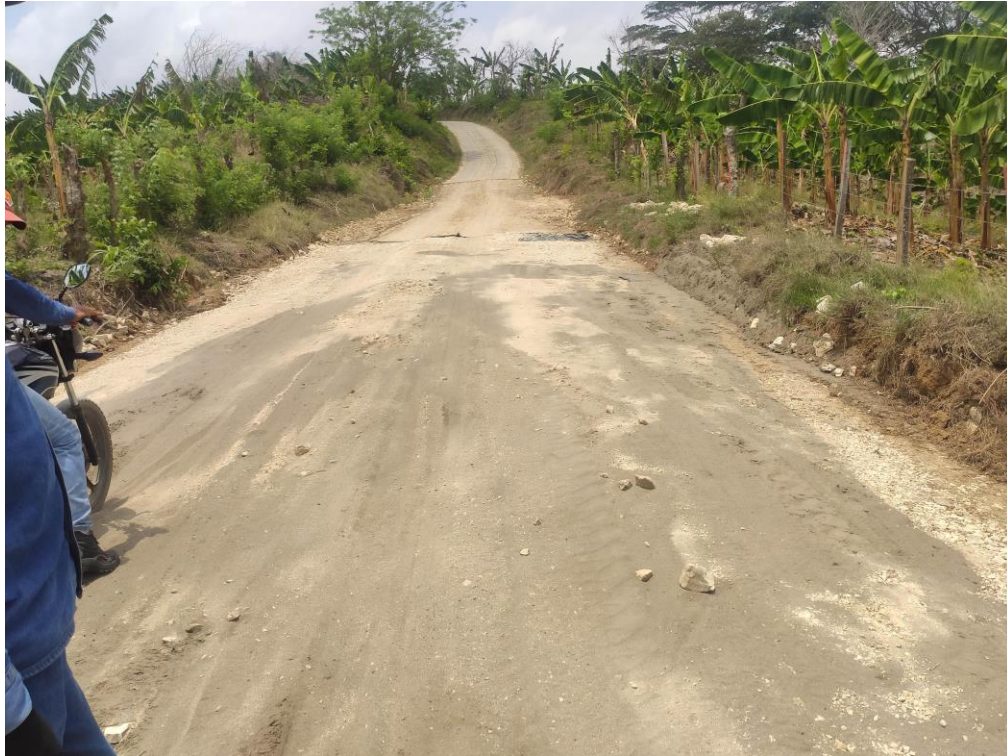
Adición de arena en zonas de material con alta plasticidad, obsérvese su acolchonamiento, que se debe corregir.
