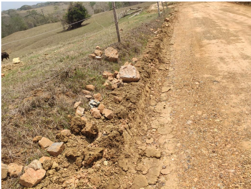
Se observa contaminación lateral con material plástico lateral.
