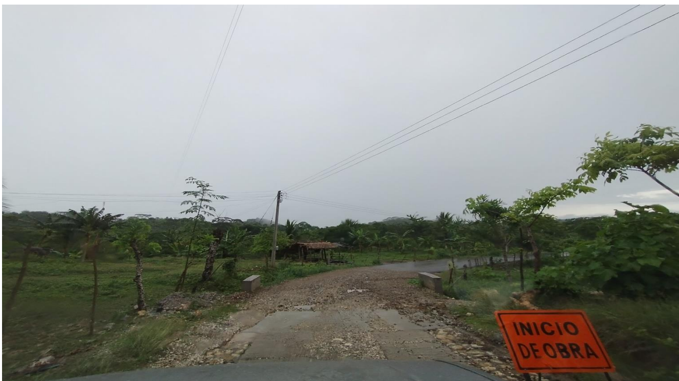
Zonas de Transición de diferentes Estructuras que con el Invierno aceleran su deterioro.
