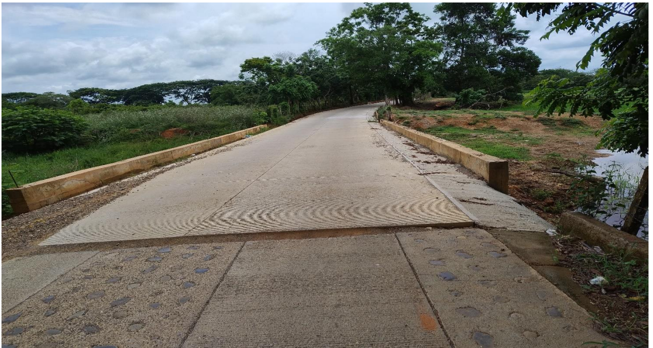
Empalme faltante entre Pavimento Rígido nuevo y Placa Huella Existente
