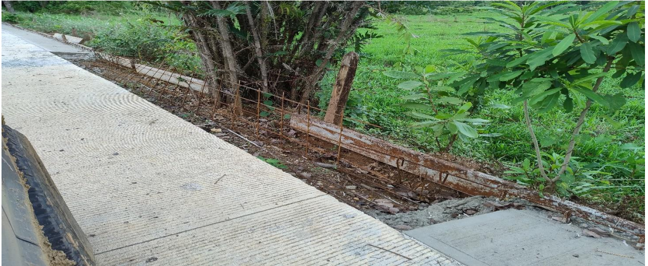
Berma cuneta con Bordillo sin terminar.
