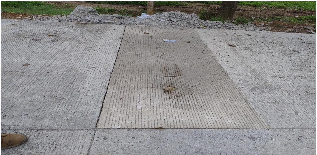
Tercio de losa reparada y de buena presentación
