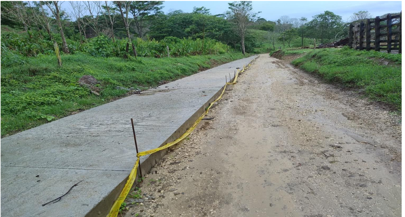
K5+820 Losas de MR 40 y Subbase Granular deteriorada por el Invierno, se deberá mejorar su apoyo.
