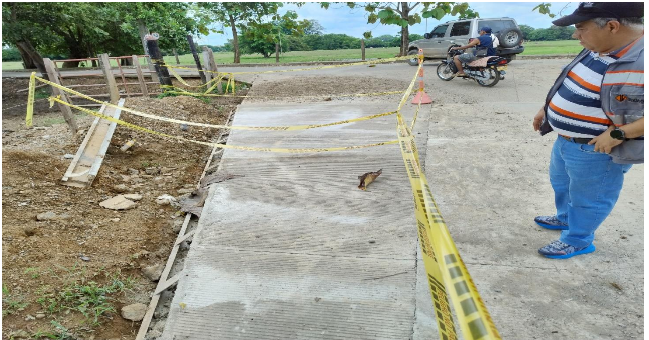
Ultimas losas Fundidas con refuerzo por no cumplir la Relación de Esbeltez.
