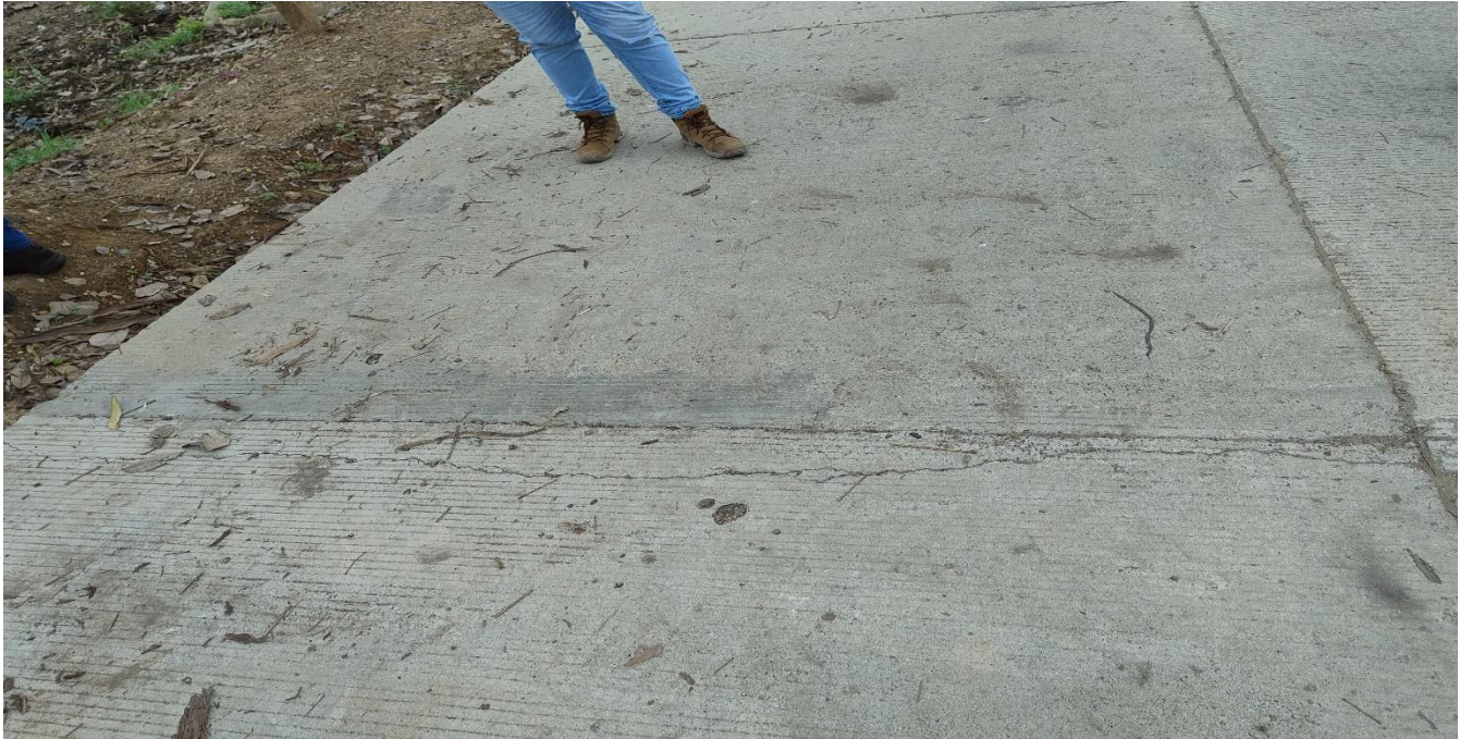
Nuevas fisuras por posible tardanza en el corte Transversal
