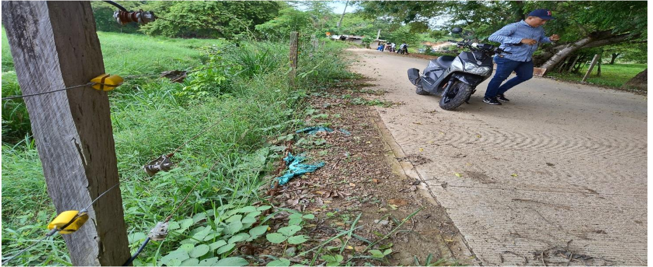
Cunetas colmatadas de residuos y Bordillos sin fundir.
