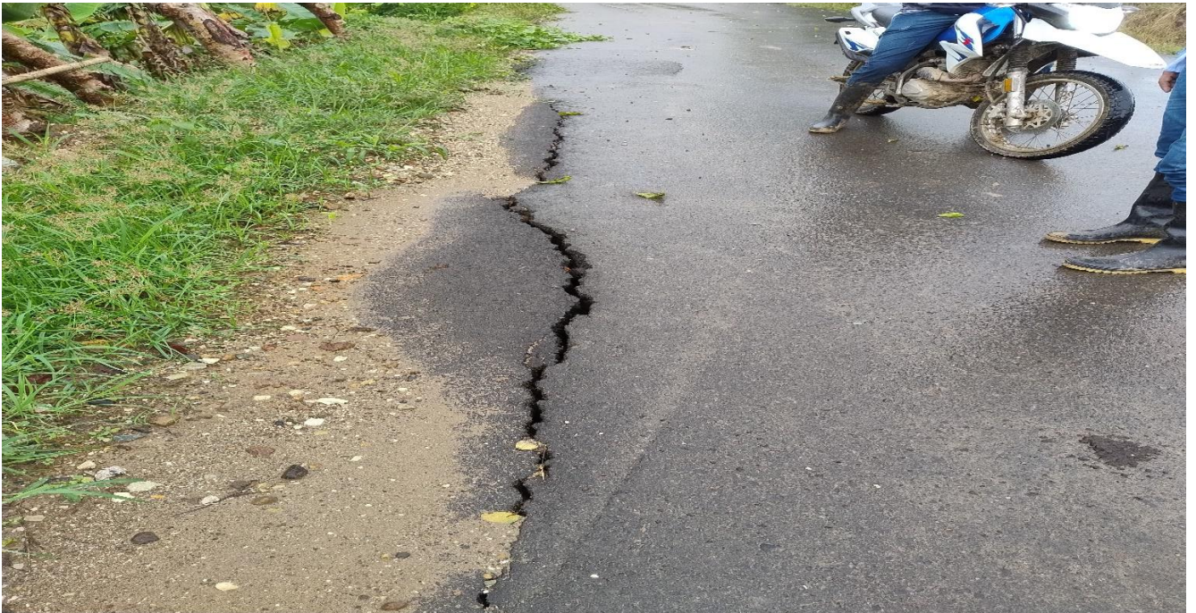
Fisuras que se convirtieron en Grietas, La Banca ya cedió y el daño de la Estructura de Pavimento colapso (Falta de Contención Lateral)
