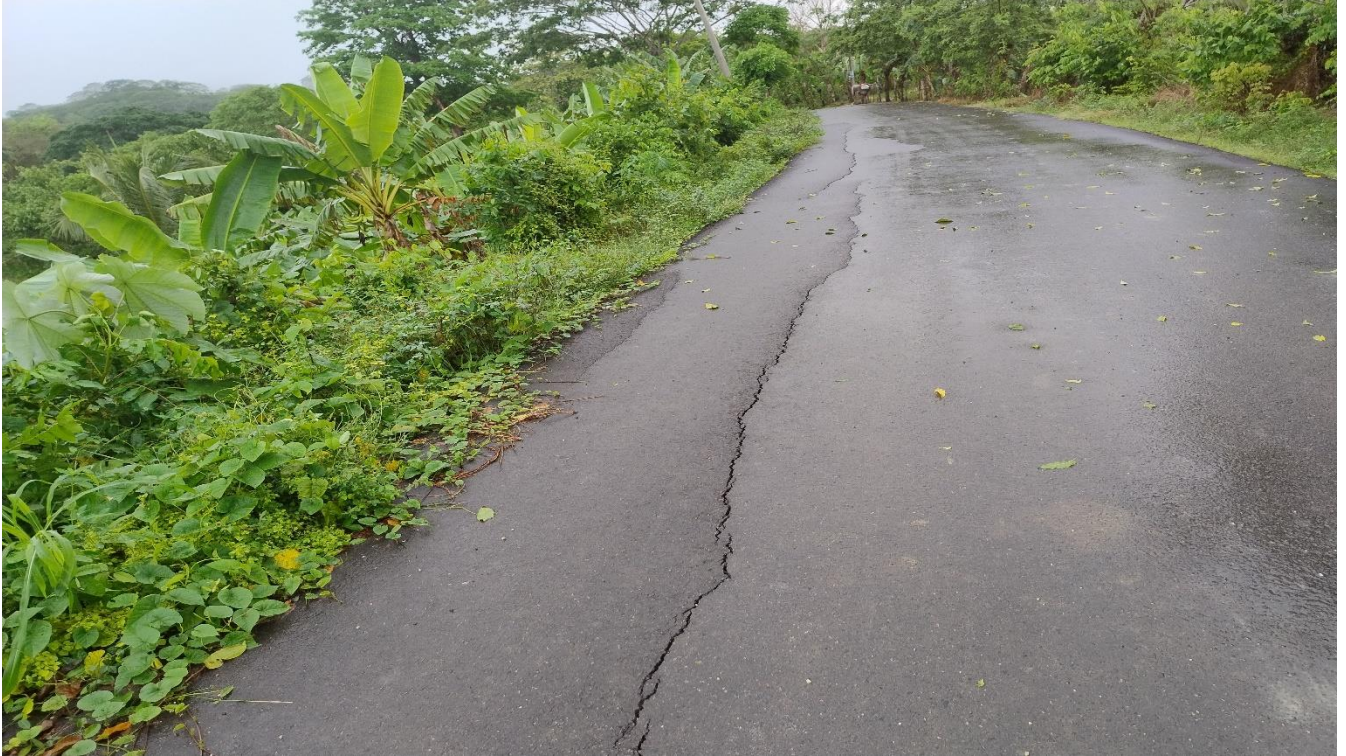
Zona Inestable por falta de Contención Lateral.
