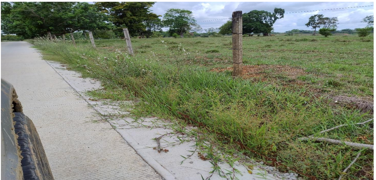
Abandono total en la construcción de los Bordillos, mas de 4 meses se fundió la losa de la Berma cuneta
