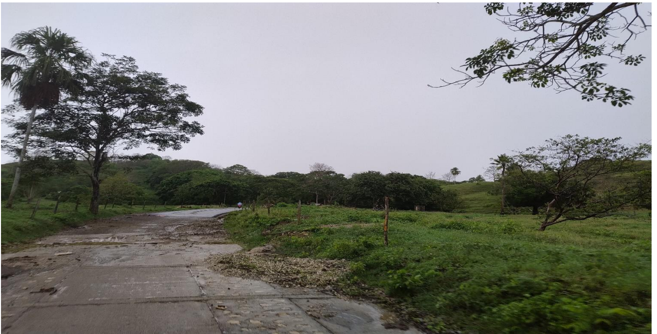
Escorrentía Superficial que afecta la Transición de Estructuras y el Drenaje no tiene un buen funcionamiento.
