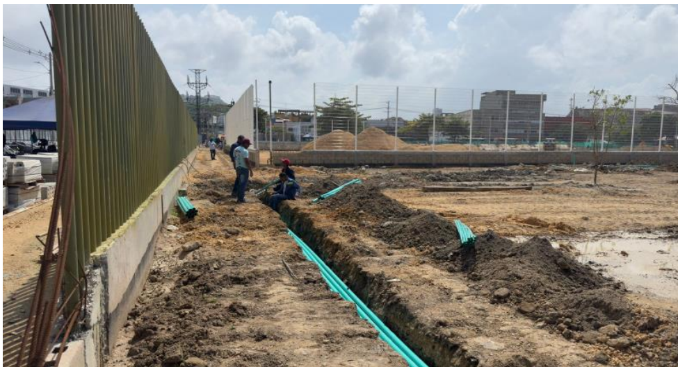
Ilustración 47. Instalaciones tuberías eléctricas iluminación
