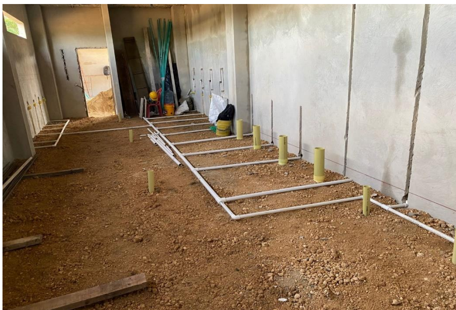
Ilustración 30. Instalaciones hidráulicas baños dugout
