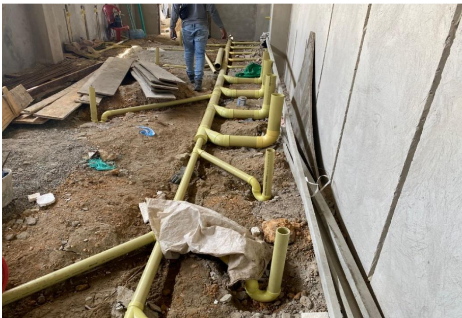
Ilustración 29. Instalaciones sanitarias baños dugout
