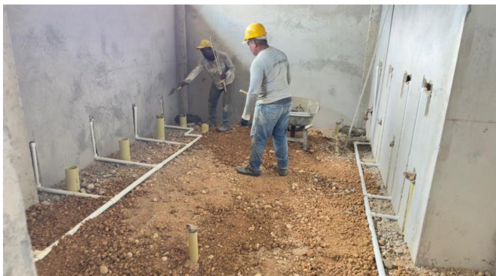
Ilustración 46. Instalaciones hidráulicas y sanitarias
