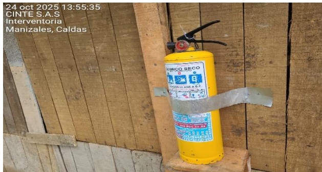
UBICACIÓN DEL EXTINTOR
