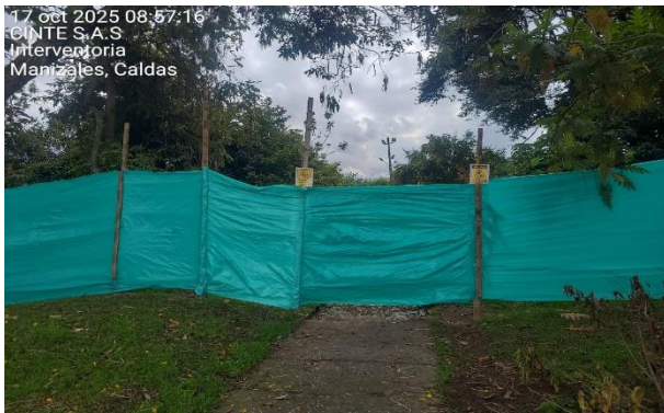
SEÑALIZACIÓN PREVENETIVA SST
