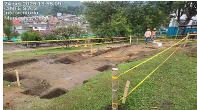
SEÑALIZACIÓN DE EXCAVACIONES
