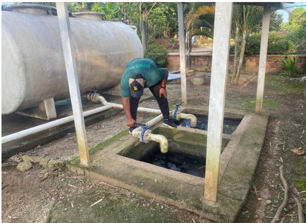
Purga de lodo del tanque de aireación.
