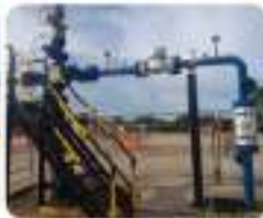
Pozo inyector Fluma 4
