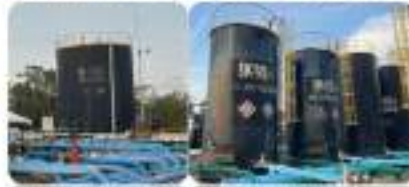
Las aguas de producción que salen de los separator llegan al settling tank tipo 1 para la separación de sólidos y luego pasan al settling tank tipo 2 para separación de gases y aceites.
