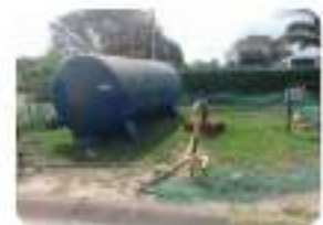
Pozo profundo Campo Rumbá.
