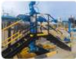
Pozo inyector Fluma 1
