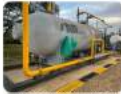
El proceso de generación de las aguas de producción entra en el separator cilíndrico.
