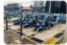
El agua de producción proveniente de los settling tank tipo 1 y 2 pasa por las bombas booster para alimentar los fillos.
