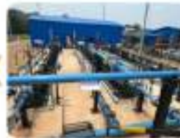
El agua proveniente de los fillos pasa por las bombas de inyección para luego ser inyectada.
