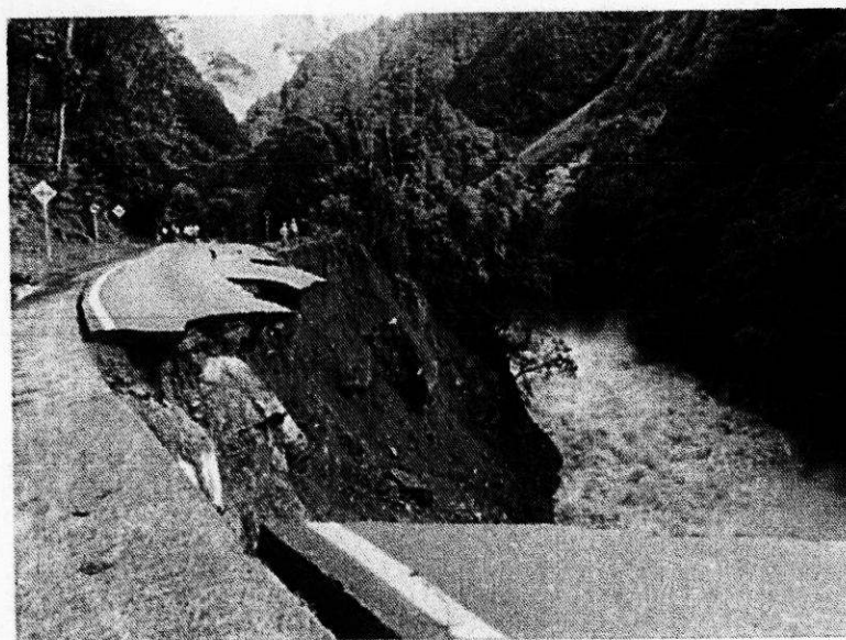
En el sector Puente Muros se presentó pérdida de banca, esto es la vía que comunica a Macanal con Santa María. Julio 17 del
