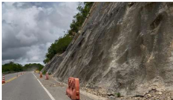
31-10-2025 Estado del área afectada.
