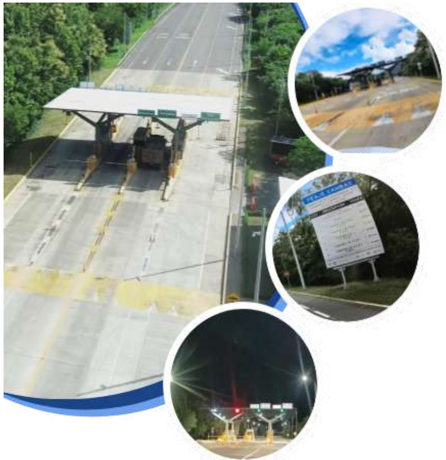
Figura 24. Hallazgos evidenciados Peaje Cambao
