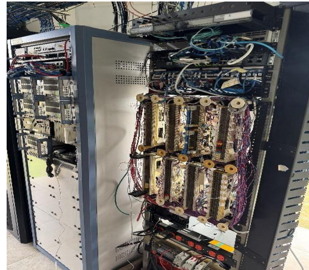
Foto 6. cambio de gabinete y reubicación de radios, equipos red ATN y multiplexor rad.
