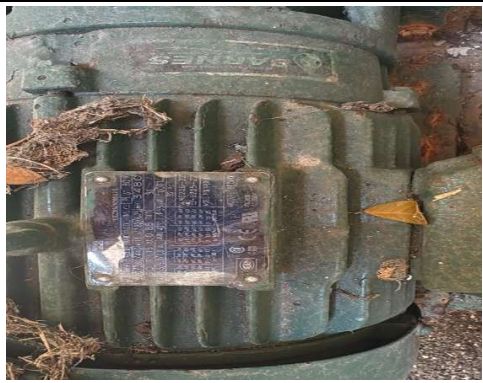
BOMBAS EN ESTADO DE ABANDONO
