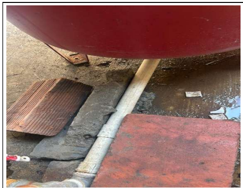
PRESENCIA DE HUMEDAD
