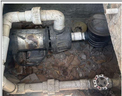
EQUIPOS DE BOMBEO EN MALAS CONDICIONES
