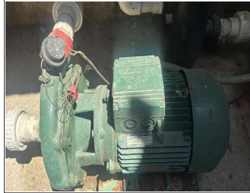
BOMBAS EN ESTADO DE ABANDONO
