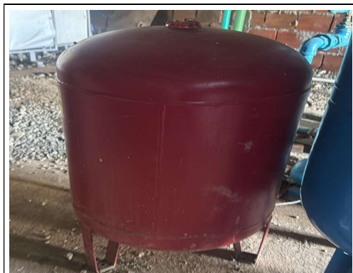
TANQUES HIDRONEUMATICOS EN MAL ESTADO
