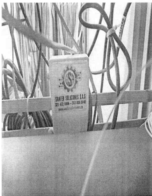
Ilustración 4 Conexión al Switch de datos de la Fibra Óptica
