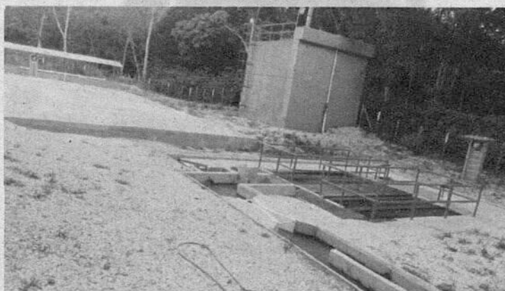
Tanques de la planta
