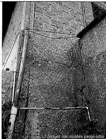
Fotografía No. 11. Grietas en fachada lateral, registradas el día 25 de Abril de 2022
