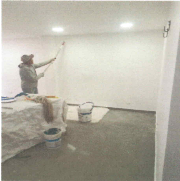
Figura 33: Muros Personería Municipal.
